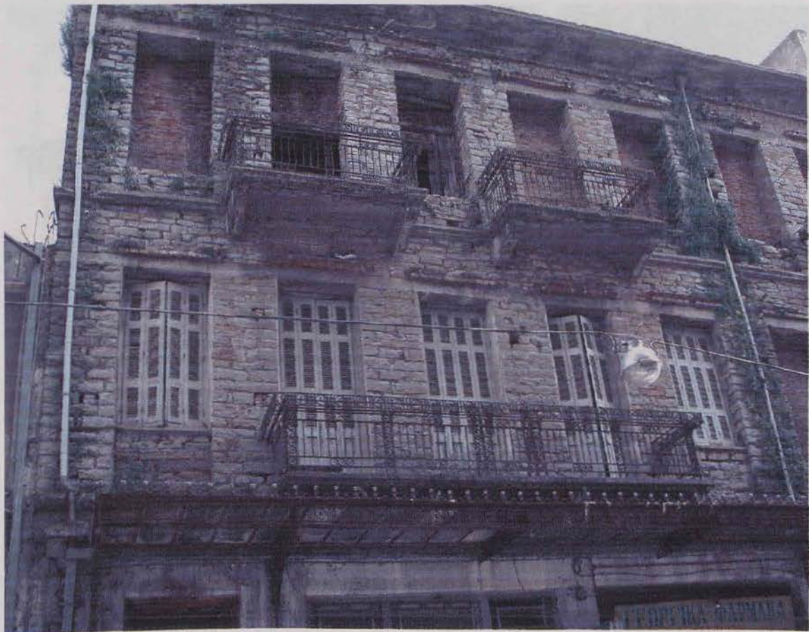
4) Εγκαταλελημένο πέτρινο κτίσμα επί της οδού Τσαλδάρη
