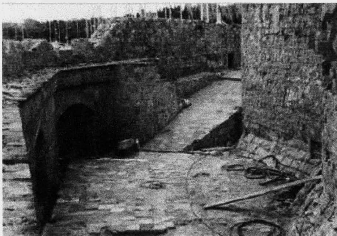
Περιτείχισμα στο εξωτερικό του φρουρίου του Αγίου Νικολάου, στο λιμάνι, Εσωτερική πλευρά του φρουρίου. Βόρεια πλευρά ( Γλώσσα Καστίλης )
