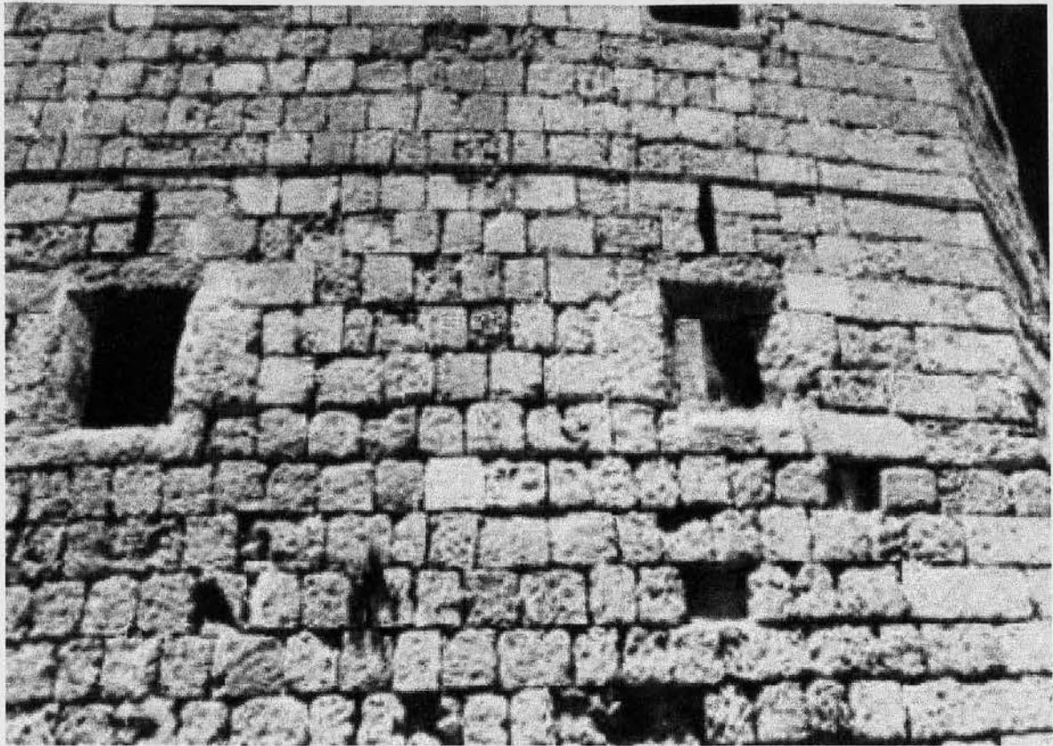
Λεπτομέρεια πάνω στο τείχος του προμαχώνα του Αγίου Ιωάννου - Κοσκινού, Εξωτερική πλευρά των τειχών. Νότια πλευρά ( Γλώσσα Προβηγγίας )
