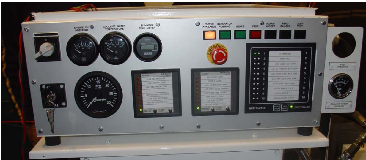
Ο τοπικός πίνακας ελέγχου ηλεκτρομηχανής
