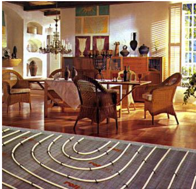
Εικόνα 1.3: Ενδοδαπέδια Θέρμανση και Αισθητική Χώρου
