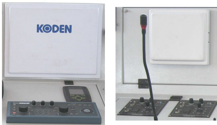
Φωτογραφία 7.5 (Πίνακας ελέγχου συσκευών ραδιοεντοπισμού )
