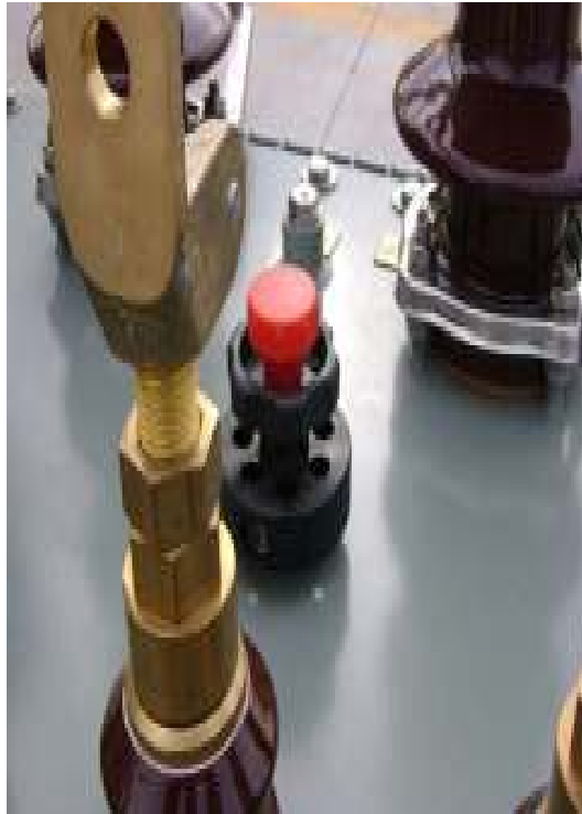
Σχήμα 6.8: Μεταγωγέας ΜΣ ΜΣ 20 / 0,4 kV
