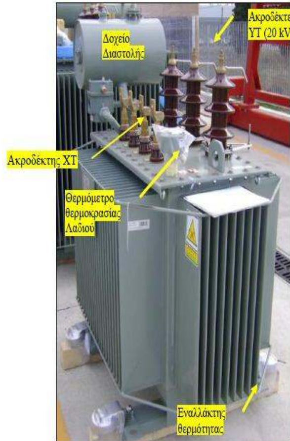
Σχήμα 5.6: Ελαιόκαρπος ΜΣ 20/0,4 kV 400kVA
