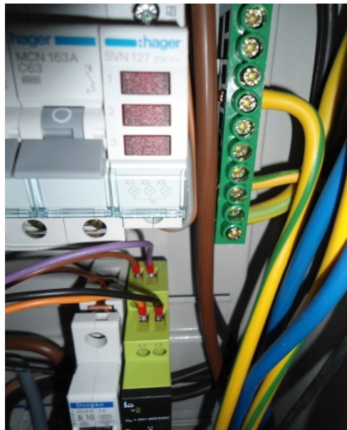
Εικόνα 12: Η περίπτωση ισοδυναμικής σύνδεσης στον ζυγό γείωσης του πίνακα κίνησης του εργαστηρίου
