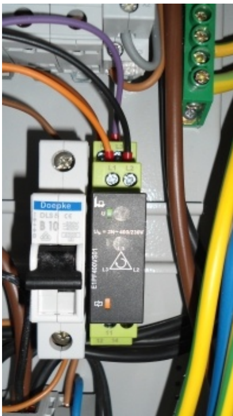
Εικόνα 6: Φωτογραφία από την τοποθέτηση επιτηρητή τάσης στον πίνακα κίνησης του Εργαστηρίου Μετρήσεων Τεχνικών Μεγεθών
