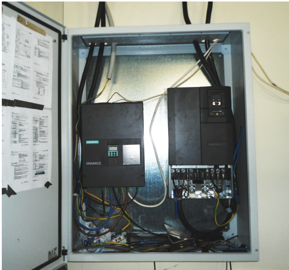
Εικόνα 1: Ο πίνακας αυτοματισμού με τα κινητήρια συστήματα σε φάση δοκιμών
