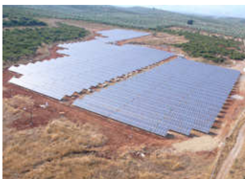
Εικόνα 1.8 : Φωτοβολταϊκό πάρκο στη Λακωνία
