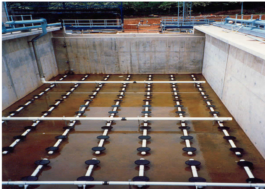
Εικόνα 3.6. Σύστημα αερισμού λυμάτων με διαχυτήρες λεπτής φυσαλίδας στο πυθμένα
