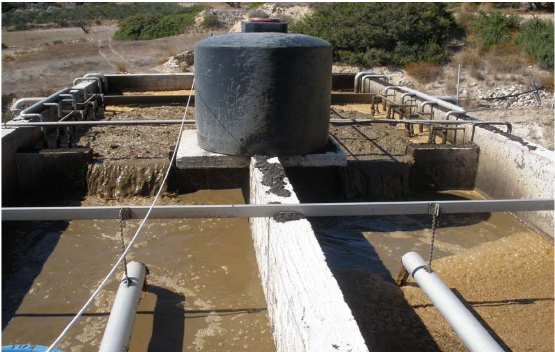
Εικόνα 3.2. Οριζόντιος αεριζόμενος αμμοσυλλέκτης – λιποσυλλέκτης εγκαταστάσεως Μήλου
