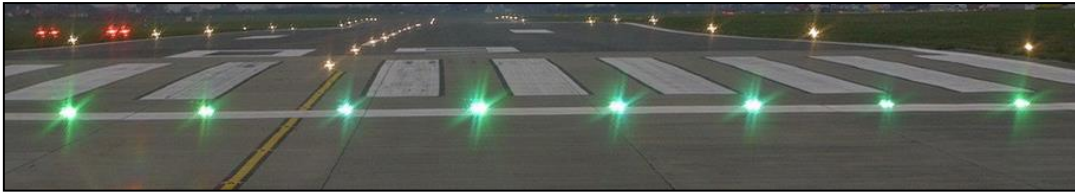
Εικόνα: Φώτα κατωφλίου
