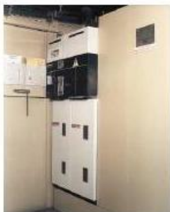
Εσωτερικός χειρισμός του αποτελούμενου από υπομονάδες πίνακα ΜΤ, ΣΜ6
