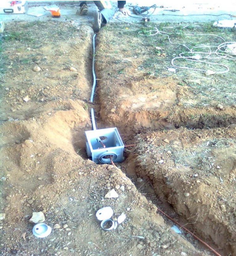
Εικόνα 4 Όδευση αγωγού γείωσης προς το κτίριο
