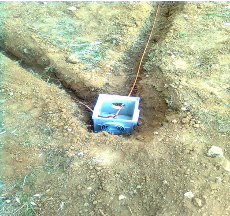
Εικόνα 3 Φρεάτιο με ηλεκτρόδιο τύπου ράβδου
