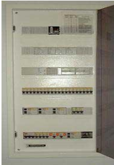
Εικόνα Νο. 13 : Πίνακας με υλικό αυτοματισμού instabus EIB KNX
