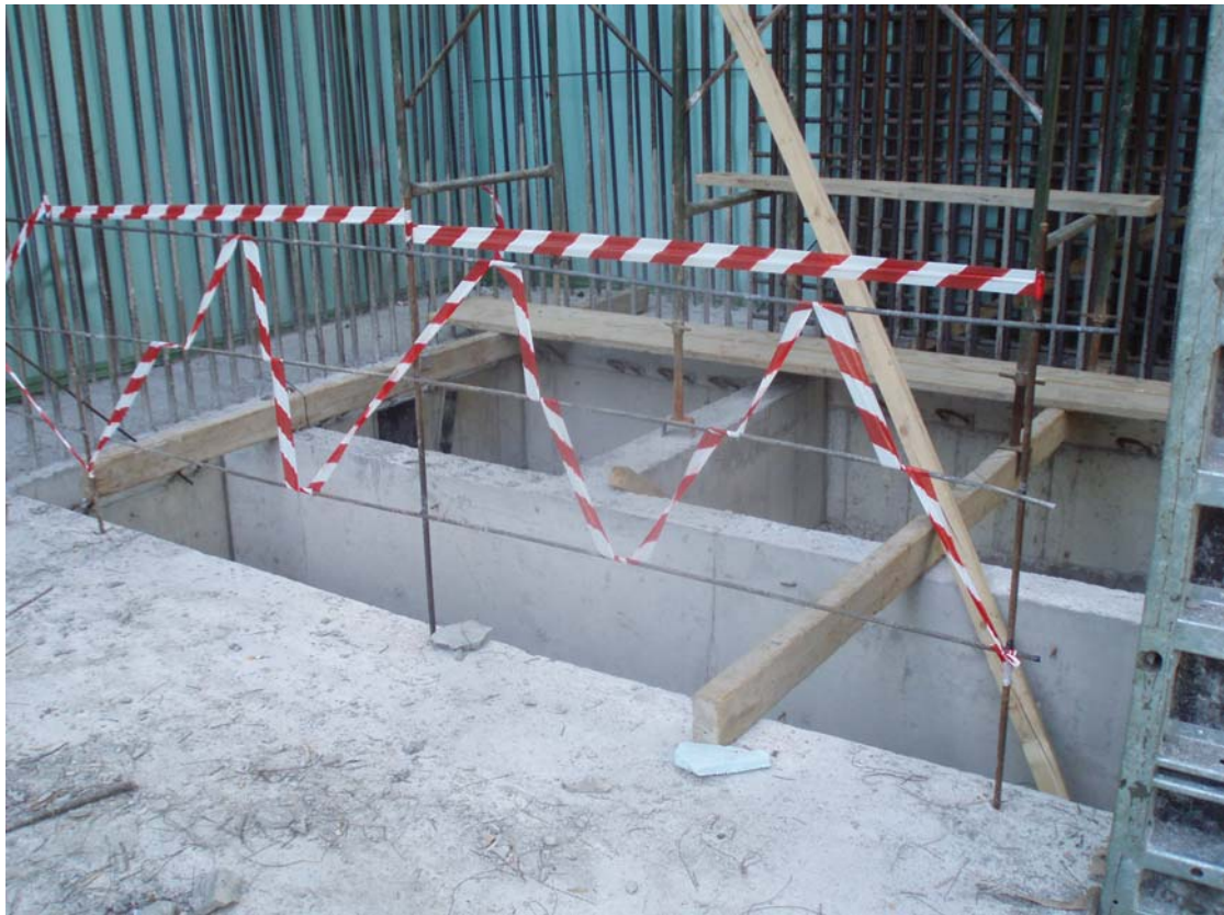
Εικόνα 23 - Καλή σήμανση και προστασία ανοίγματος έναντι πτώσης
