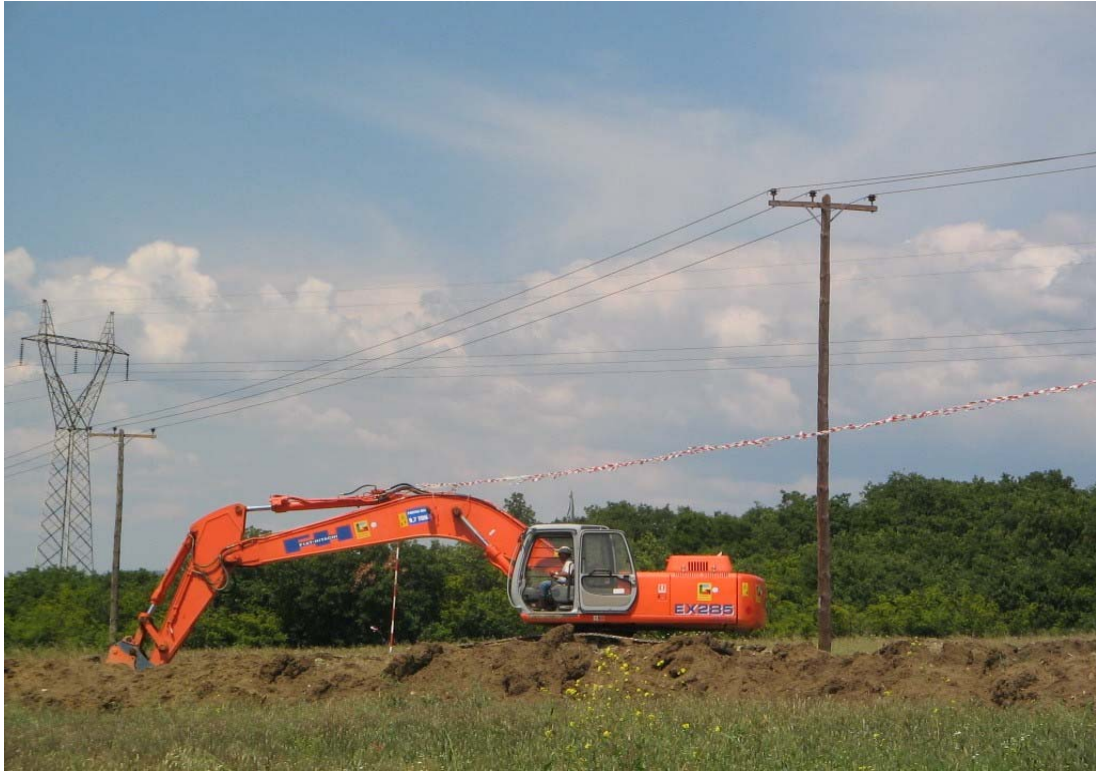
Εικόνα 26 - Μηχάνημα πολύ κοντά σε δίκτυο ηλεκτροδότησης - Απαράδεκτη σήμανση
