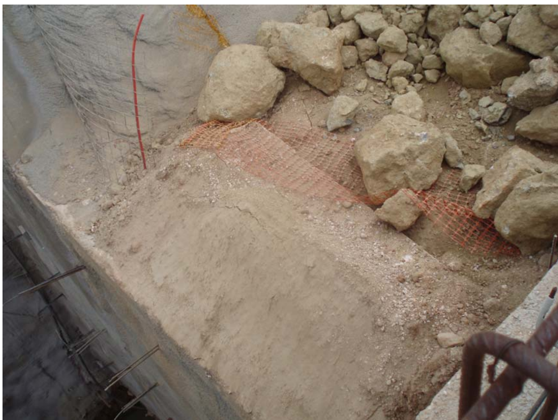
Εικόνα 10 - Δεν υπάρχει προστασία έναντι πτώσης και η απαγορευτική σήμανση έχει καταπλακωθεί
