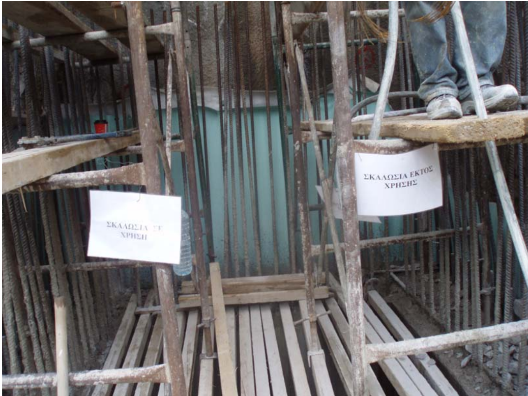
Εικόνα 8 - Ευδιάκριτη σήμανση για την σκαλωσιά, χωρίς όμως να είναι ασφαλώς τοποθετημένη και το πιο σημαντικό ο εργάτης δεν λαμβάνει υπόψην του την σήμανση
