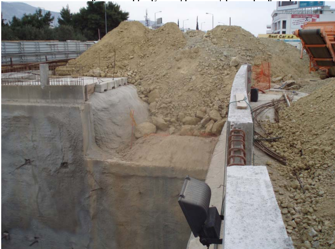
Εικόνα 9 - Δεν υπάρχει αντιστήριξη και τα χώματα της εκσκαφής πέφτουν στο εργοτάξιο
