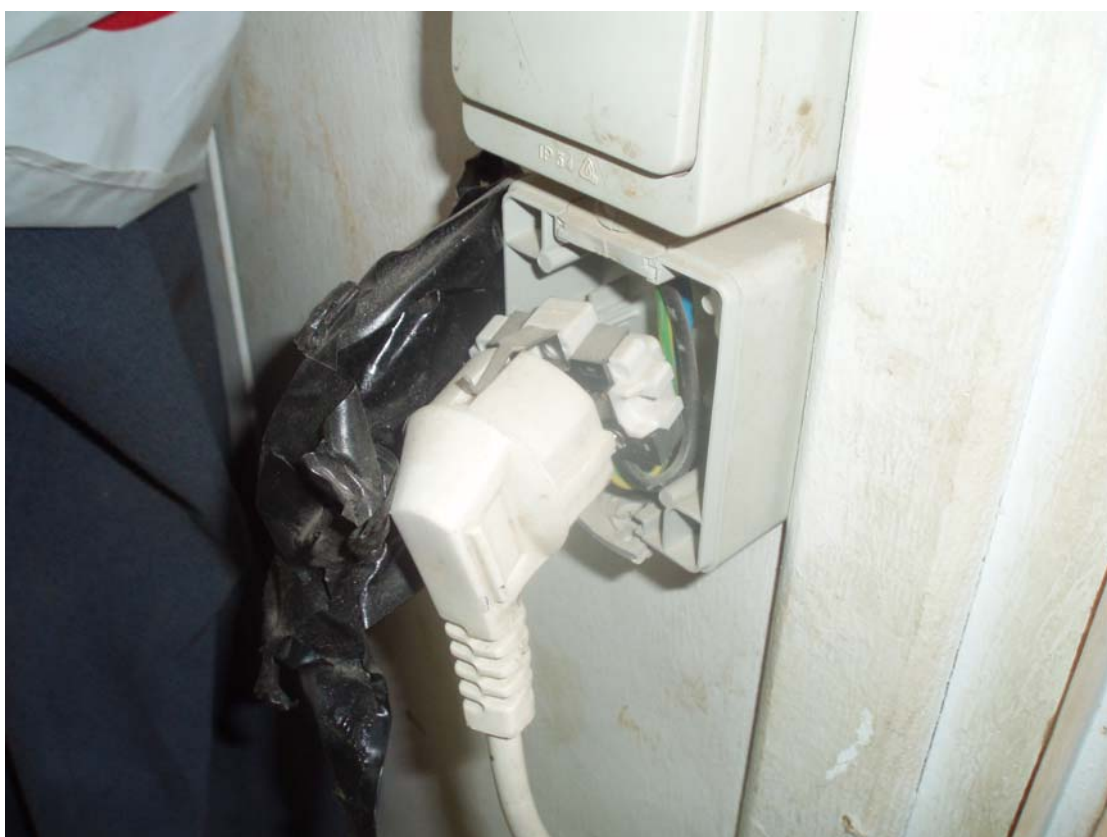
Εικόνα 22 - Απαράδεκτο σύστημα ηλεκτροδότησης στον χώρο εστίασης των εργαζομένων
