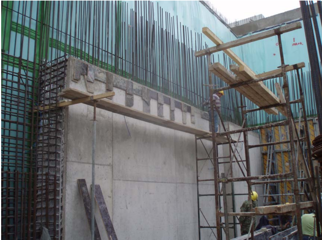
Εικόνα 6 - Σκαλωσιά χωρίς προστασία έναντι πτώσης
