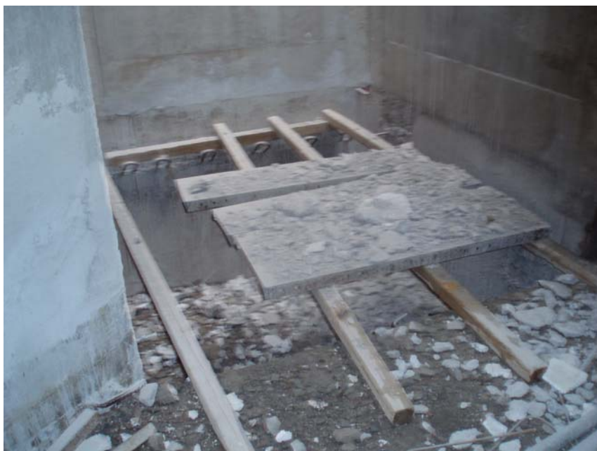
Εικόνα 1 - Απαράδεκτη προστασία ανοίγματος
