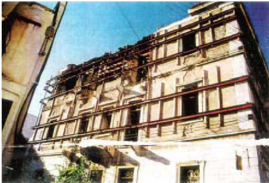
Εικ. 5.47: Άποψη νότιας όψης κτιρίου. Διακρίνεται η περιοχή κατάρρευσης.
