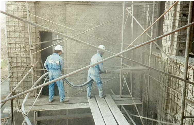
Εικ. 7.30: Εφαρμογή εκτοξευόμενου σκυροδέματος σε φέρουσα τοιχοποιία, από εξειδικευμένο προσωπικό και χρήση κατάλληλου εξοπλισμού.
