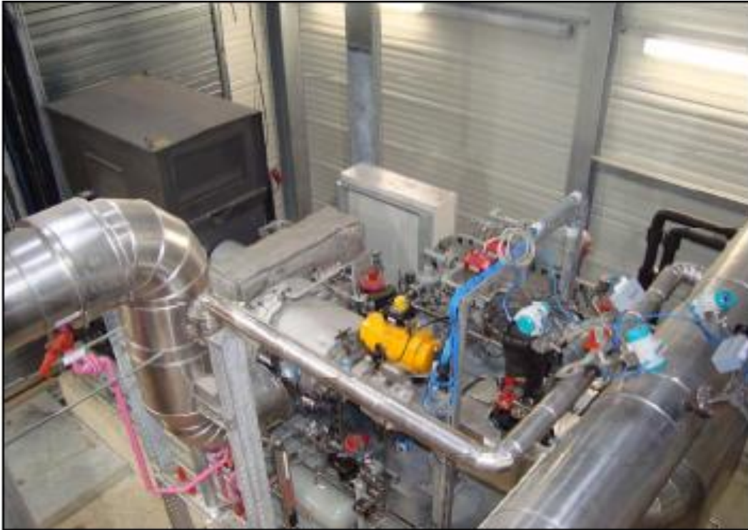
Σχήμα 2.5: Εργοστάσιο κύκλου Kalina 557,4 kw με στρόβιλο Euler τοποθετημένο
