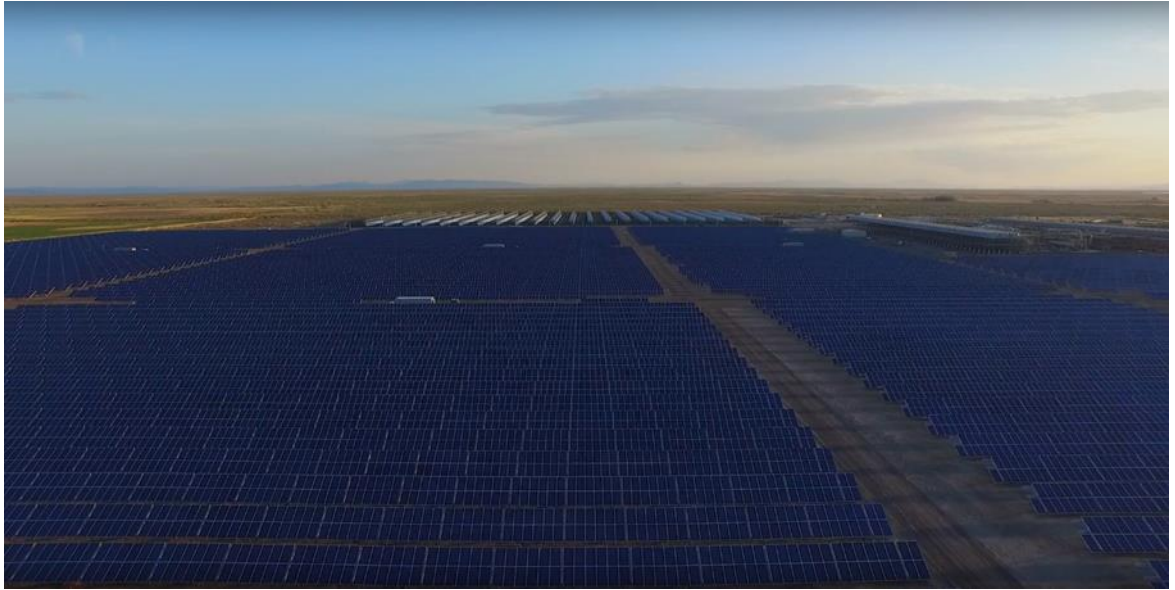
Σχήμα 7.9 Πεδίο φωτοβολταϊκών πλαισίων στο Stillwater της Νεβάδα, ΗΠΑ. (Enel's Stillwater video snapshot) [45].
