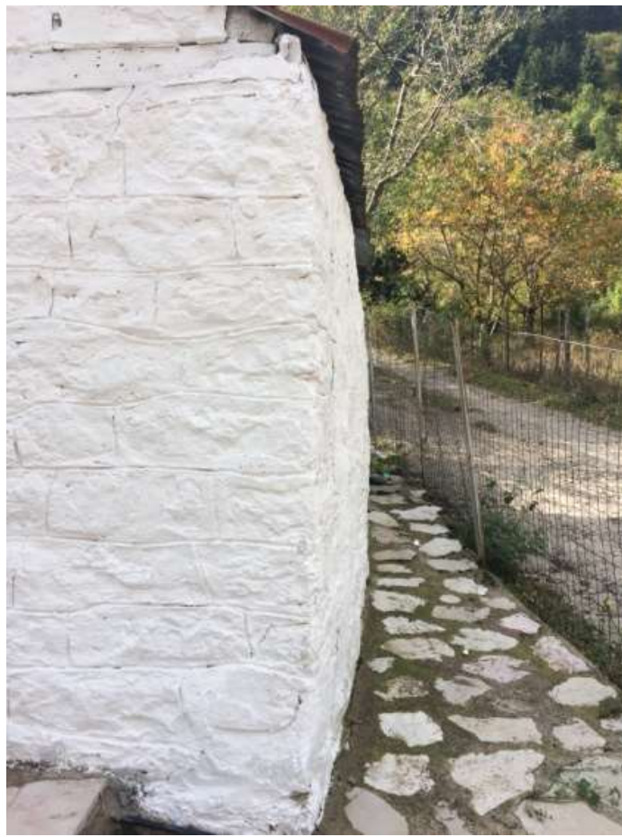
Εικόνα 38: Αστοχία εκτός επιπέδου, οικία ανώνυμη
