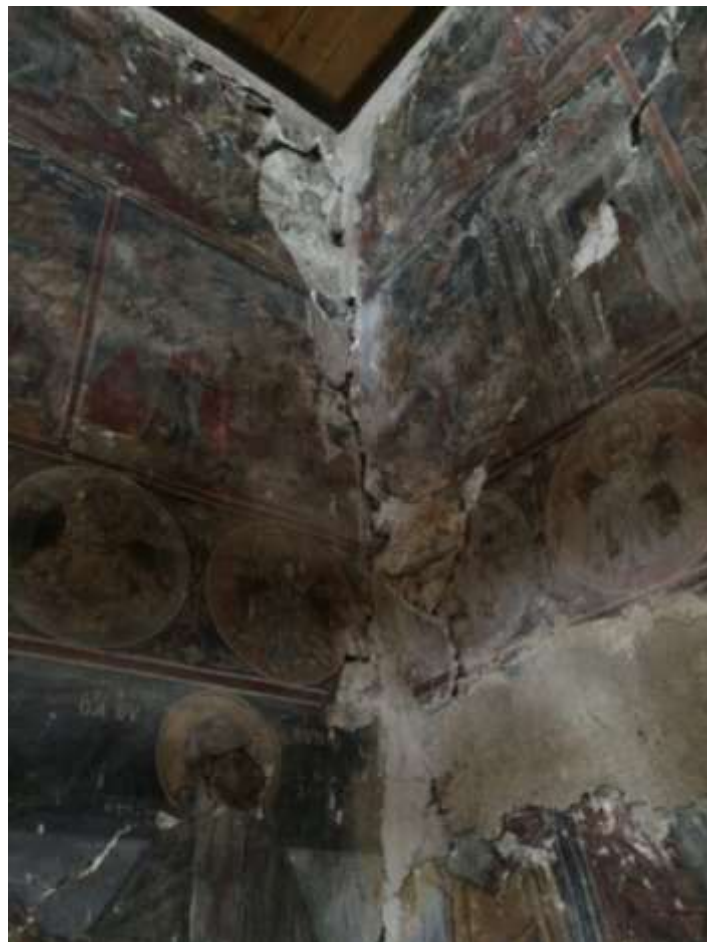
Εικόνα 12: Ρωγμές στις γωνίες του Ναού
