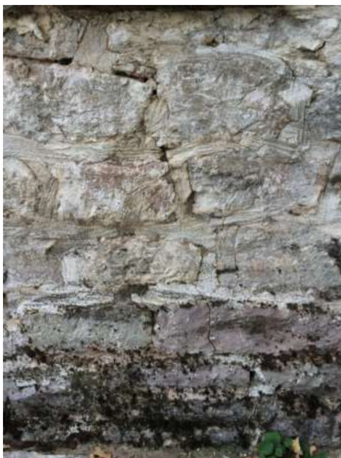
Εικόνα 24: Ρωγμές στον νότιο τοίχο
