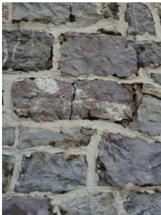
Εικόνα 25: Ρωγμές στον νότιο τοίχο
