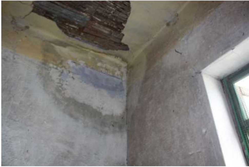
Εικόνα 70: Οι φθορές στο εσωτερικό του κτιρίου
