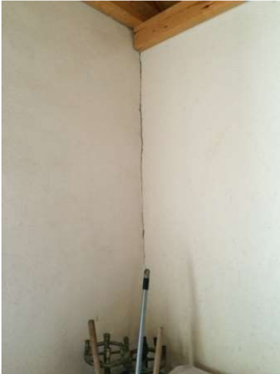
Εικόνα 30: Ρωγμές στις γωνίες του ναού
