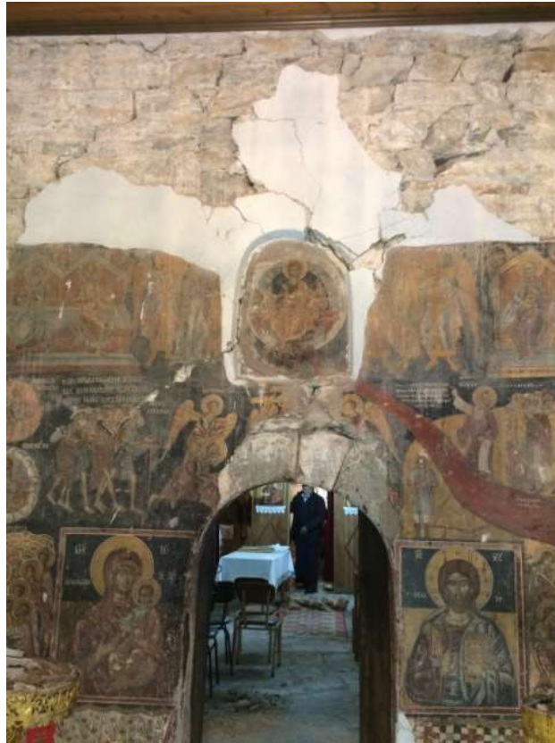
Εικόνα 8: Ρωγμές στον τοίχο που χωρίζει το νάρθηκα με τον κυρίως ναό
