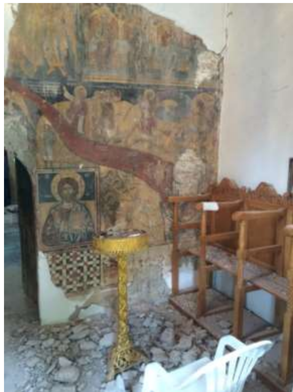
Εικόνα 9: Φθορές στον νάρθηκα του ναού
