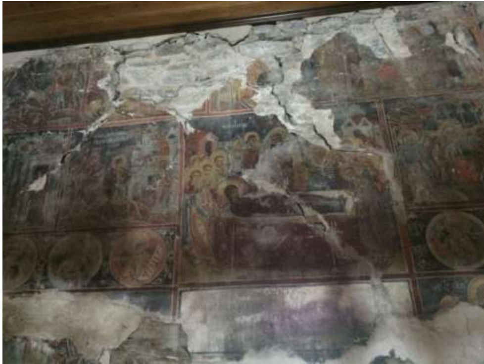
Εικόνα 11: Ρωγμές στον δυτικό τοίχο του ναού
