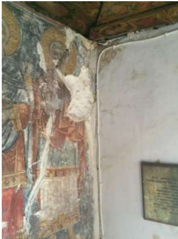
Εικόνα 20: Ρωγμές στον κυρίως Ναό
