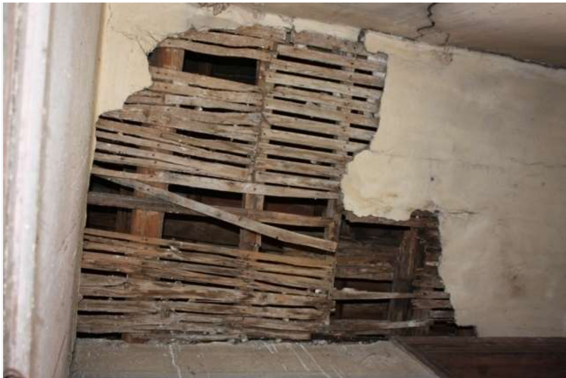
Εικόνα 71: Οι φθορές στο εσωτερικό του κτιρίου
