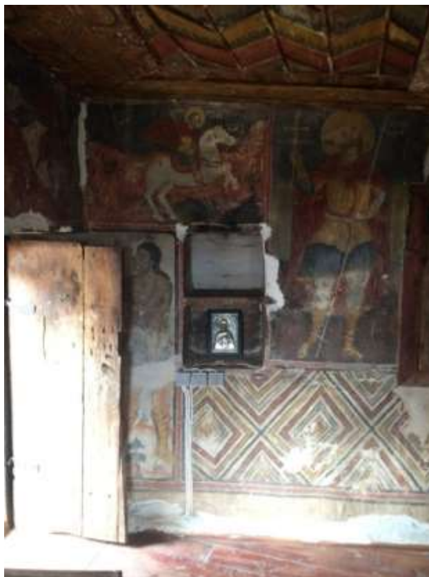
Εικόνα 17: Χαρακιές σε τοιχογραφίες στον ανατολικό τοίχο
