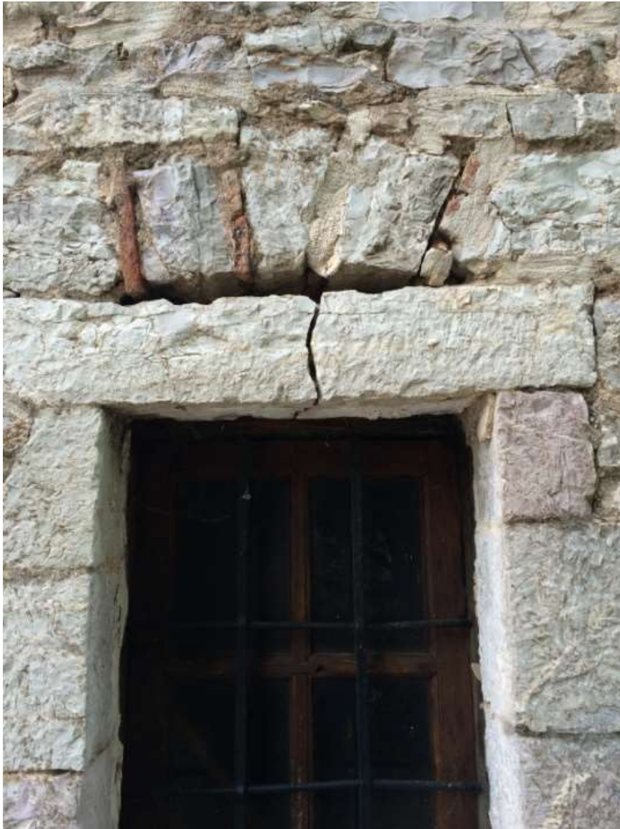
Εικόνα 26: Ρωγμή στο ανώφλι του νότιου τοίχου
