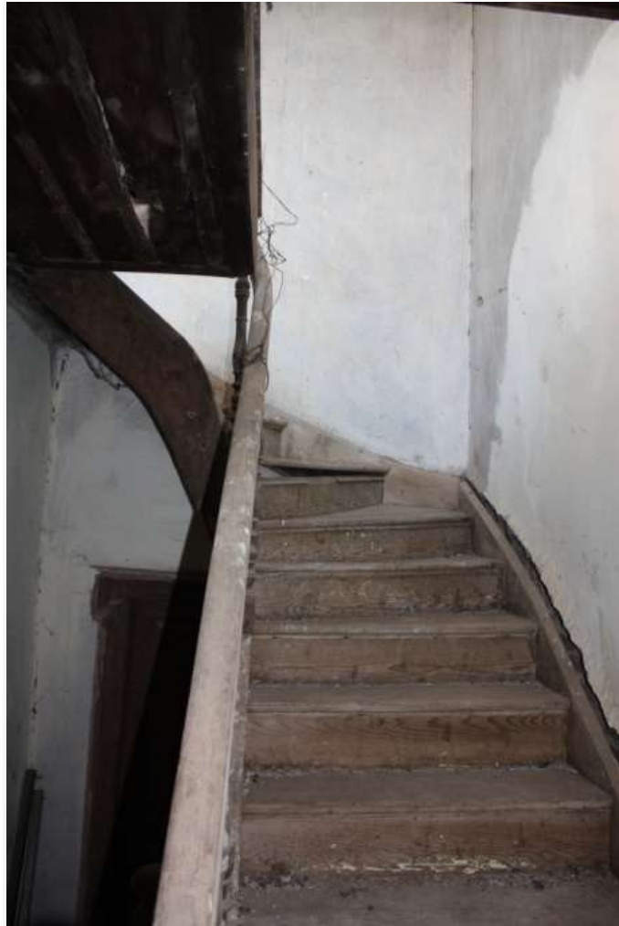
Εικόνα 69: Οι φθορές στο εσωτερικό του κτιρίου
