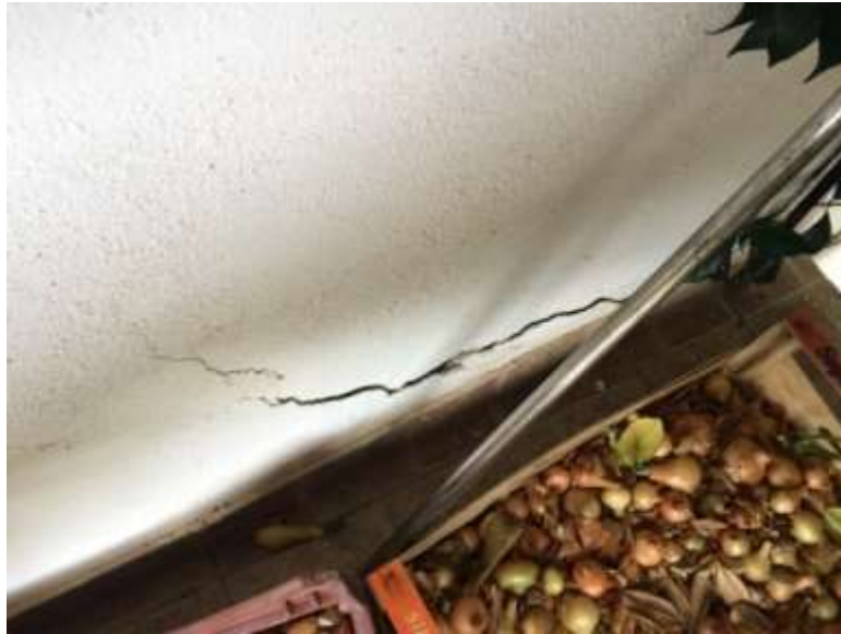
Εικόνα 50: Ρωγμές στον εξωτερικό χώρο
