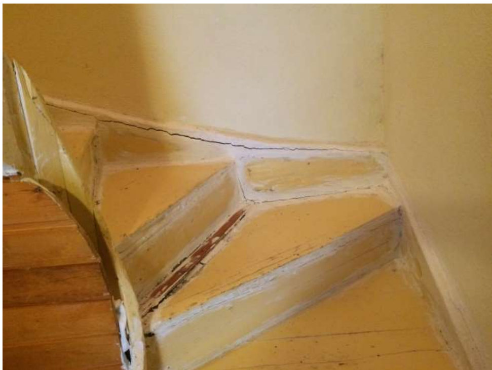
Εικόνα 51: Ρωγμές και αποκόλληση της σκάλας
