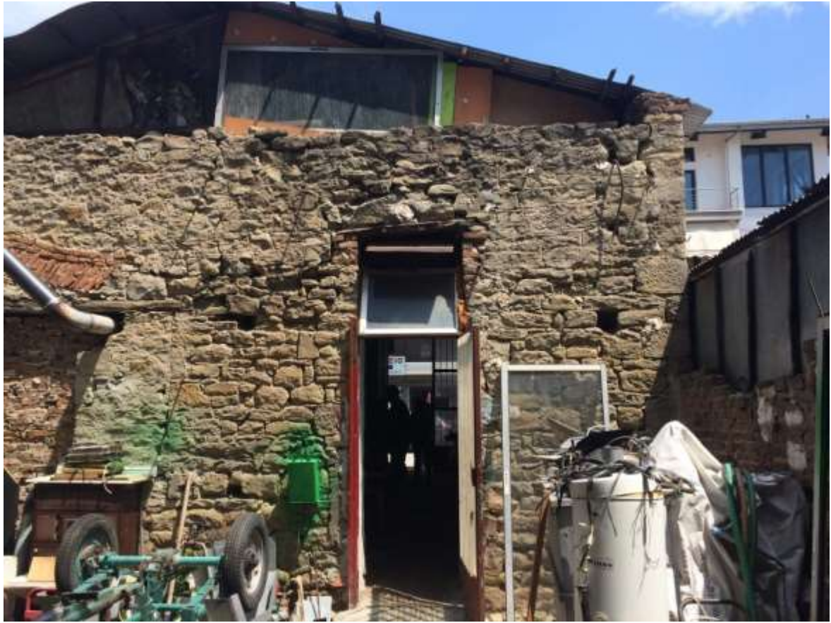
Εικόνα 60: Ζημιές στον πίσω μέρος του κτιρίου
