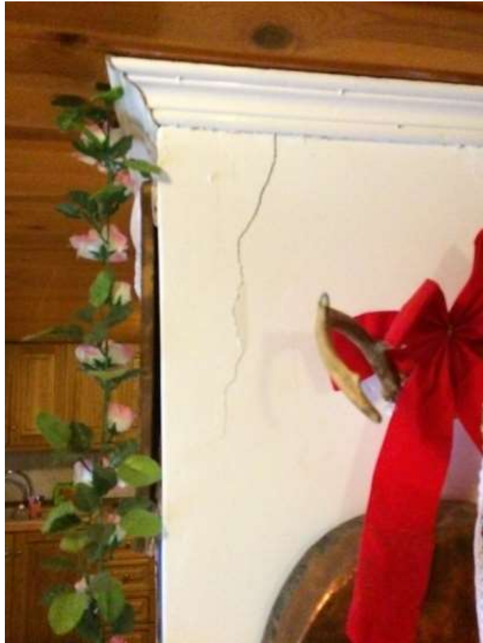
Εικόνα 52: Ρωγμές στον εσωτερικό χώρο
