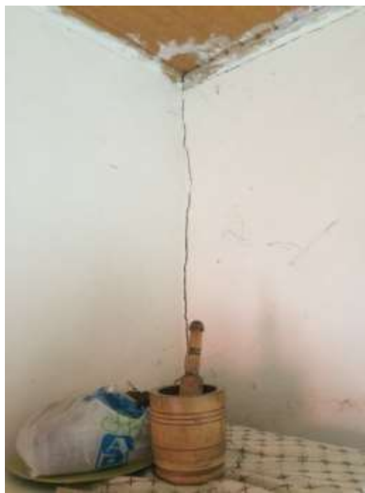
Εικόνα 43: Ρωγμές στο εσωτερικό
