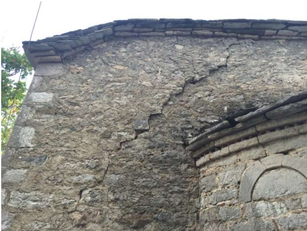
Εικόνα 22: Ρωγμή στο ανατολικό τοίχο
