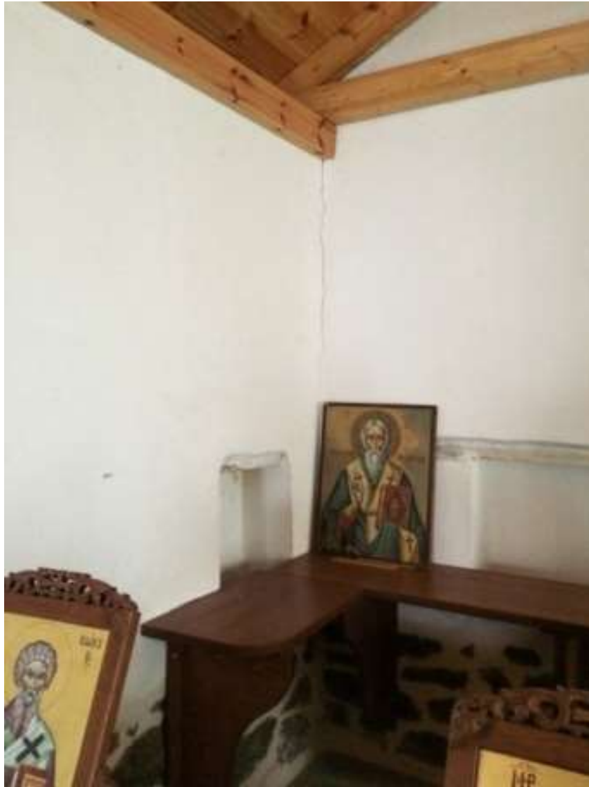
Εικόνα 29: Ρωγμές στις γωνίες του ναού
