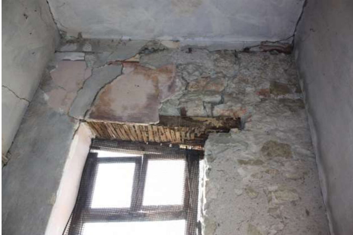
Εικόνα 68: Οι φθορές στο εσωτερικό του κτιρίου
