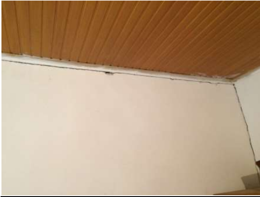
Εικόνα 44: Ρωγμές στο εσωτερικό, οικία Μακρή
