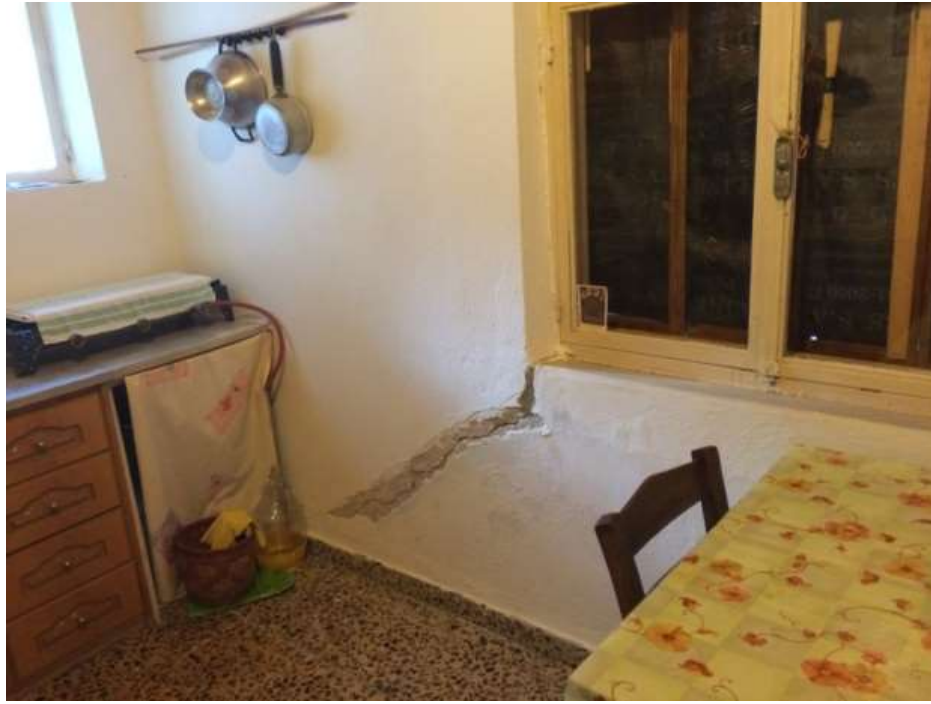
Εικόνα 36: Ρωγμές στον εσωτερικό χώρο
