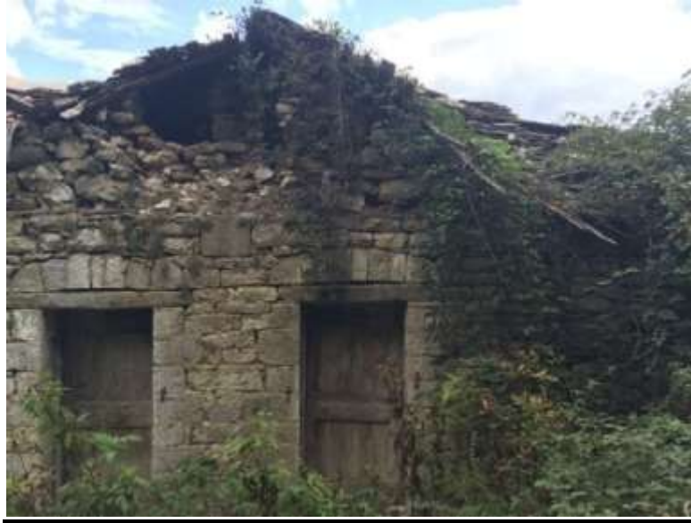
Εικόνα 40: Φθορές στην στέγη, οικία Μπαλανέων
