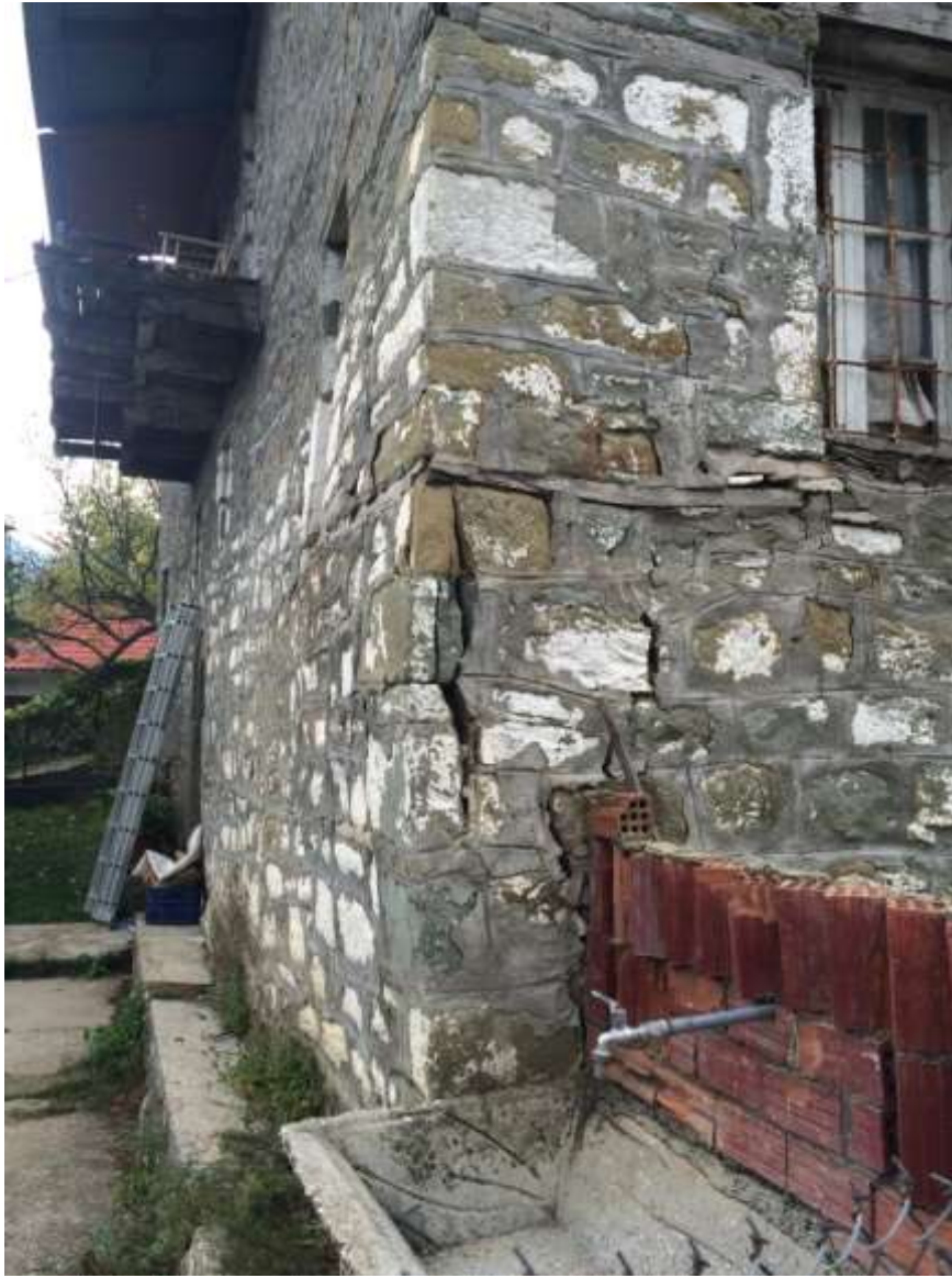
Εικόνα 46: Ρωγμές στην γωνία της οικίας
