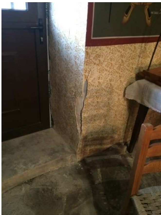
Εικόνα 28: Ρωγμές στον κυρίως Ναό
