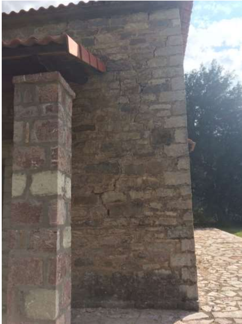
Εικόνα 7: Ρωγμές στην ανατολική όψη του Ναού
