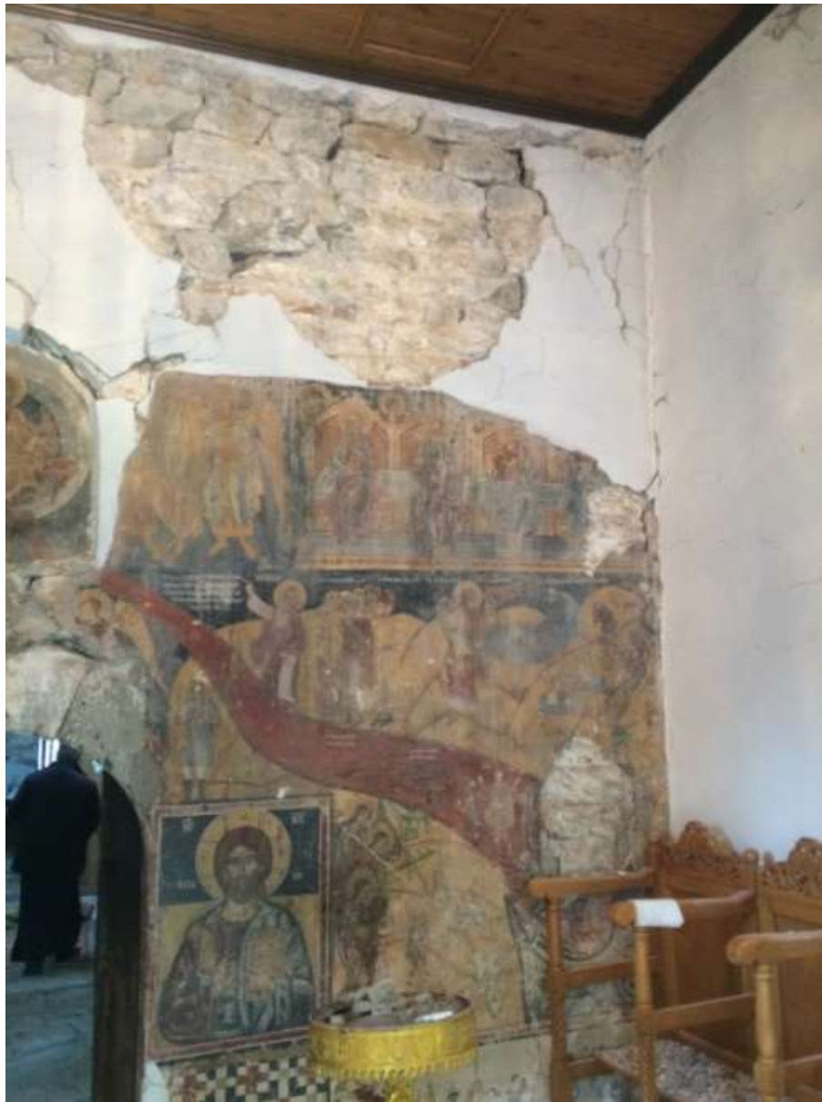
Εικόνα 10: Ρωγμές στο τοίχο που χωρίζει τον νάρθηκα από τον κυρίως ναό
