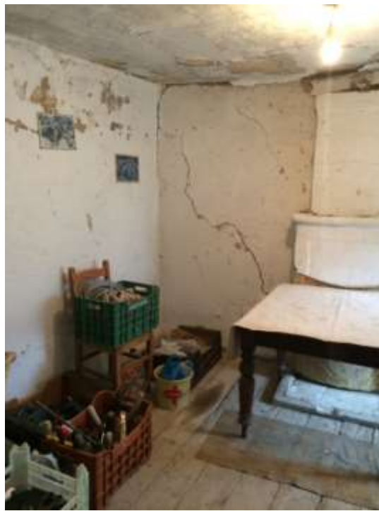
Εικόνα 48: Ρωγμές στο εσωτερικό
