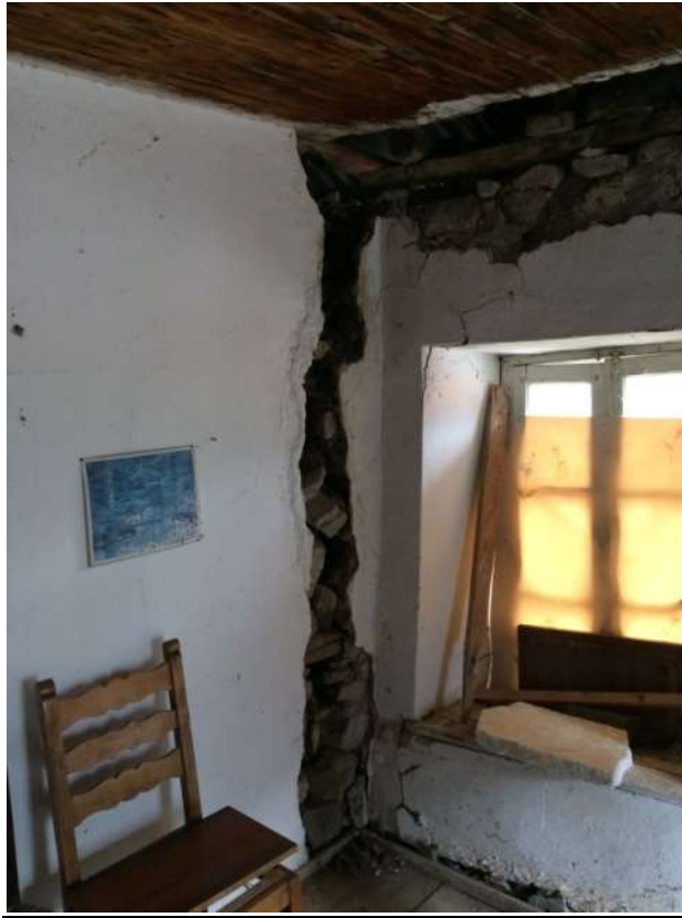
Εικόνα 47: Ρωγμές και αστοχία εκτός επιπέδου στον πλάγιο τοίχο
