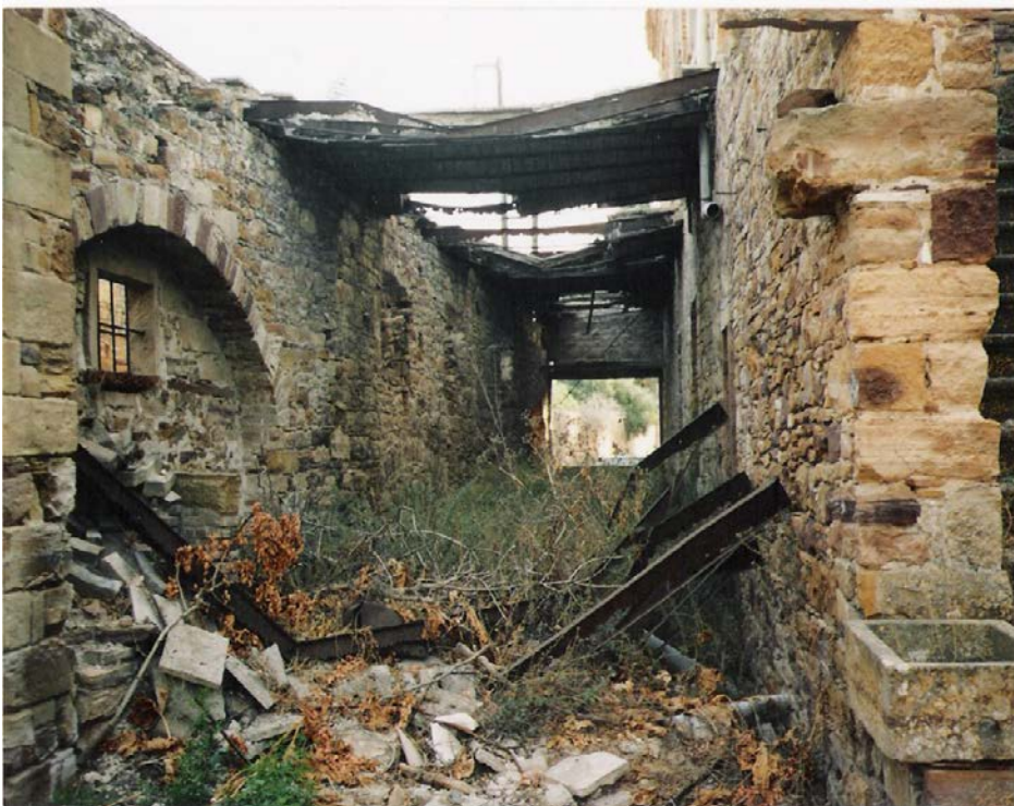
γενική άποψη παρασκευαστηρίου όπου παρατηρείται έντονα η κατάρρευση της στέγης
