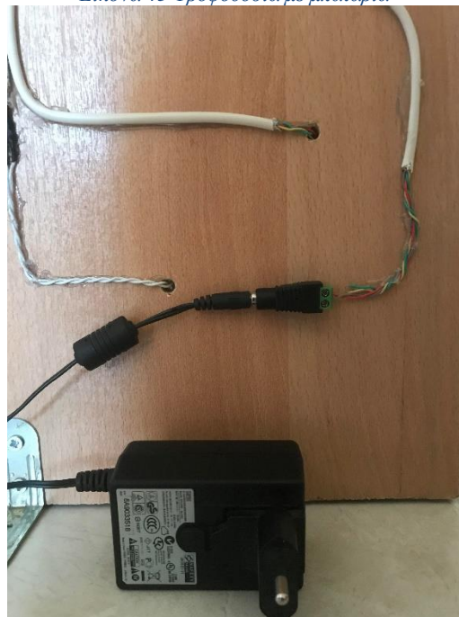
Εικόνα 44-Τροφοδοσία με τροφοδοτικό
