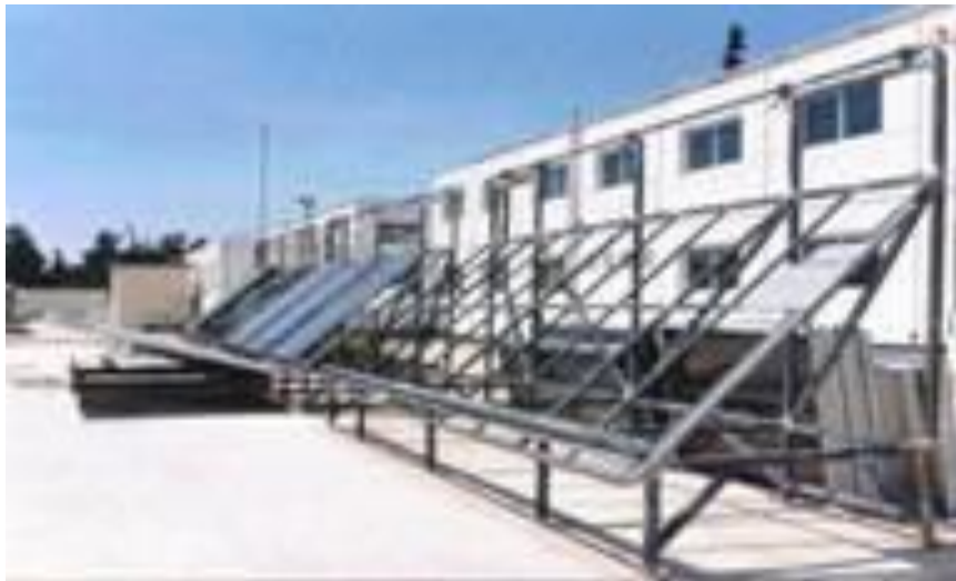
Εικόνα 2.2 : Εγκαταστάσεις εργαστηρίου δοκιμών Δημόκριτος [9]
