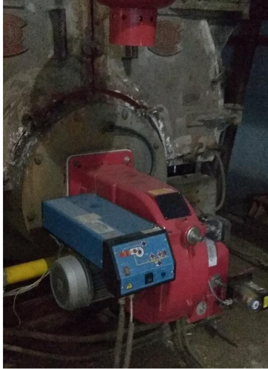
Εικόνα 6: Υφιστάμενος λέβητας Πολεμικού Μουσείου με τη χρήση νέου τύπου καυστήρα φυσικού αερίου
