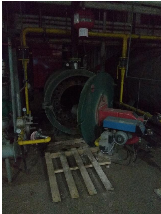
Εικόνα 7: Νέας τεχνολογίας λέβητας Φυσικού αερίου.
