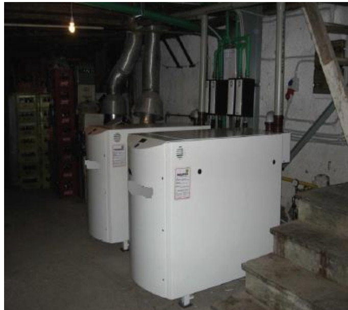
Εικόνα 4.4: Εξωτερική άποψη του ξενοδοχείου και άποψη από τις εγκαταστάσεις συμπαραγωγής
