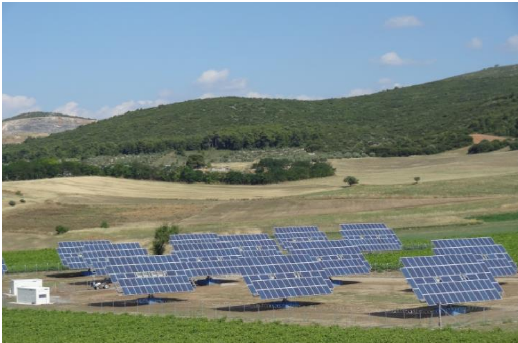
Εικόνα 1.3: Εγκατάσταση περιστροφικών διαξονικών φ/β πλαισίων
