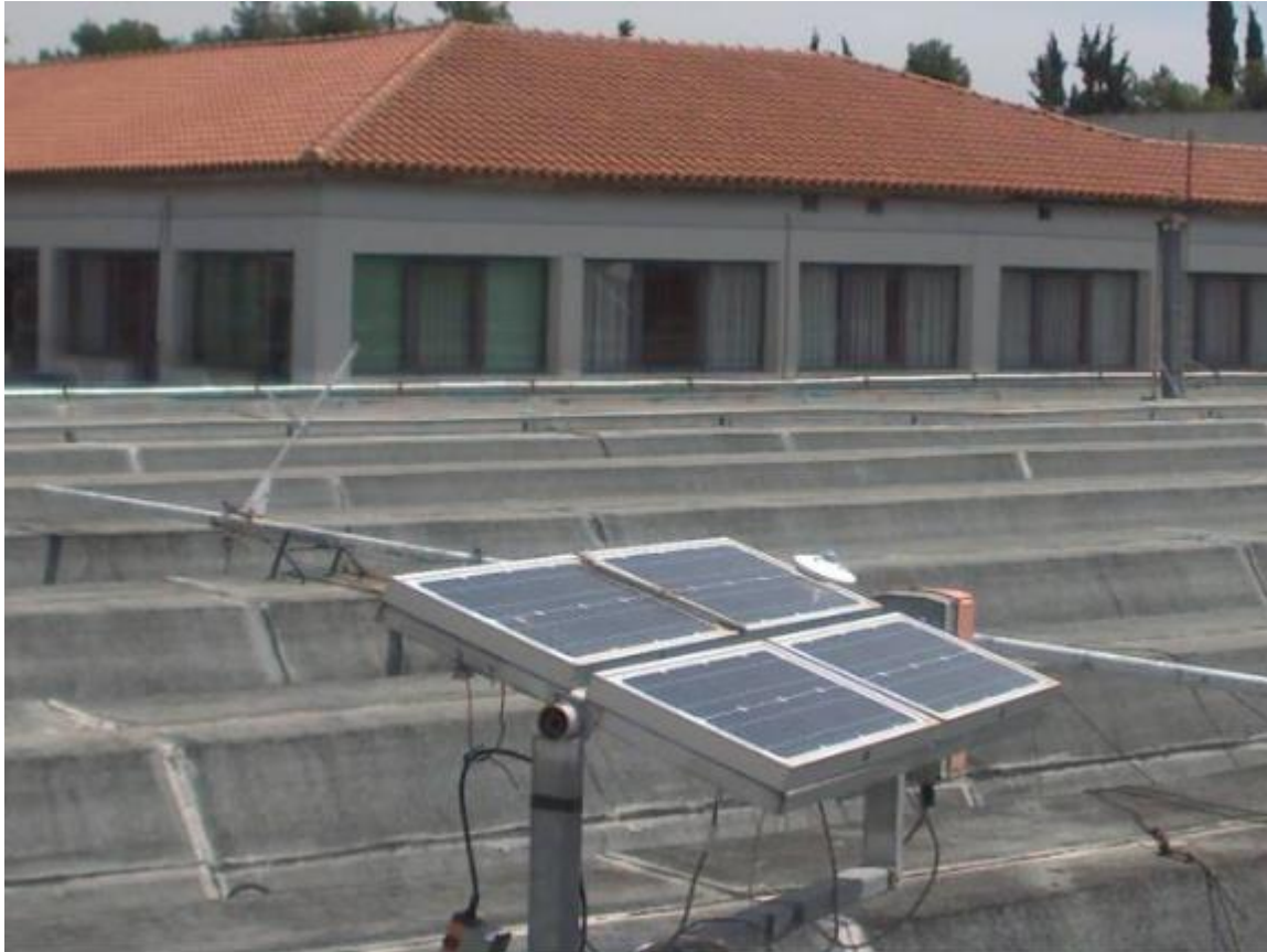
Εικόνα 3.12: Εικόνα κάμερας εγκατάστασης
