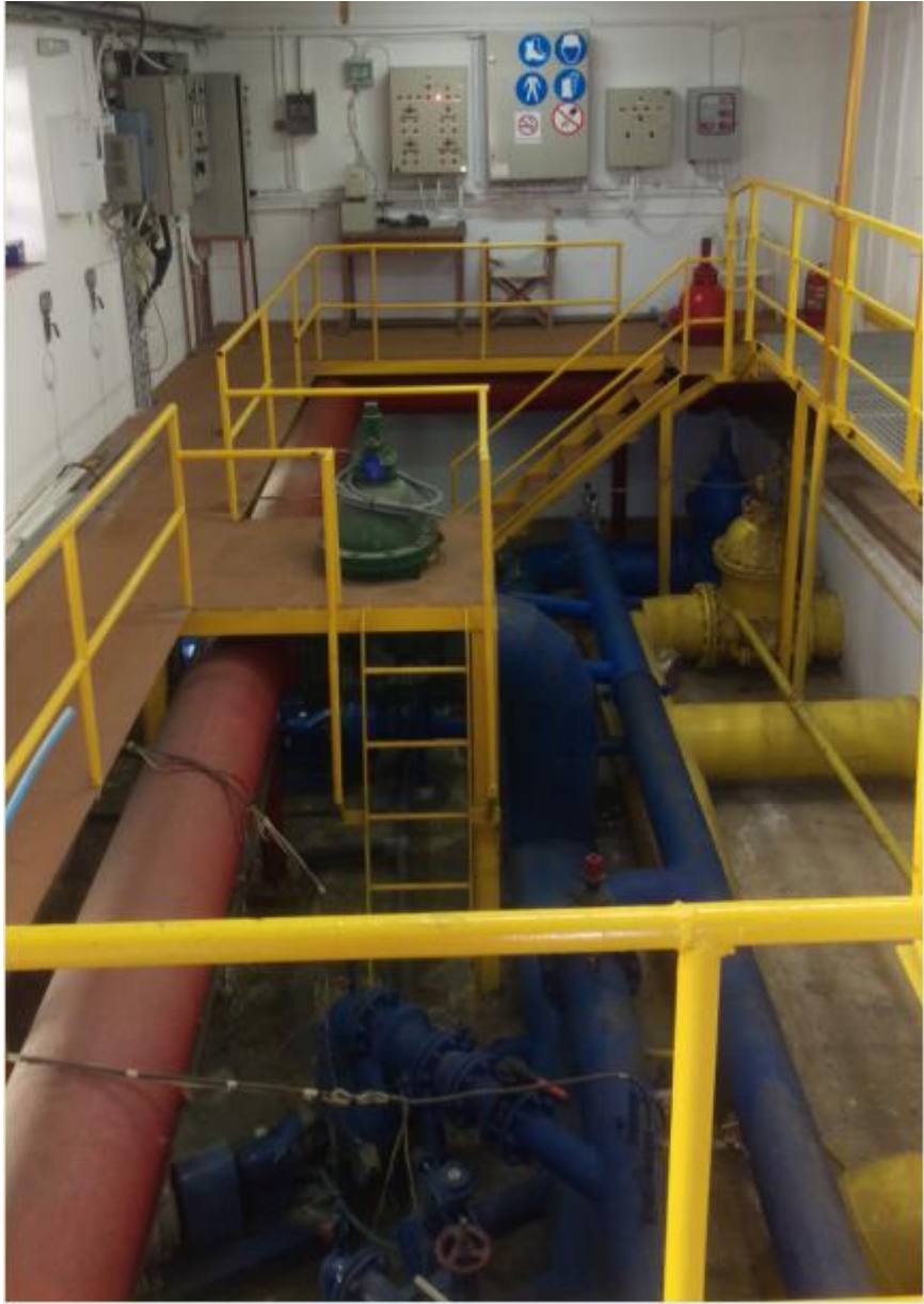
Εικόνα 3.8 Εσωτερικός χώρος εγκατάστασης δεξαμενής N2. [5].
