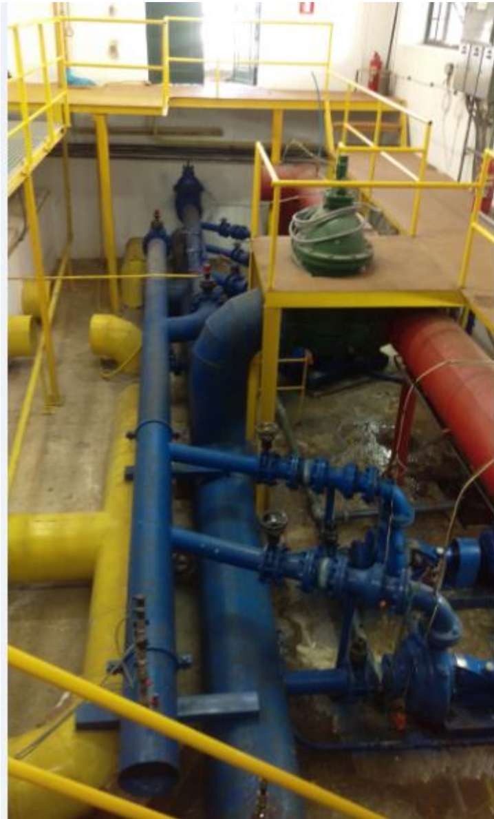
Εικόνα 3.7 Εσωτερικός χώρος εγκατάστασης δεξαμενής N1. [5].
