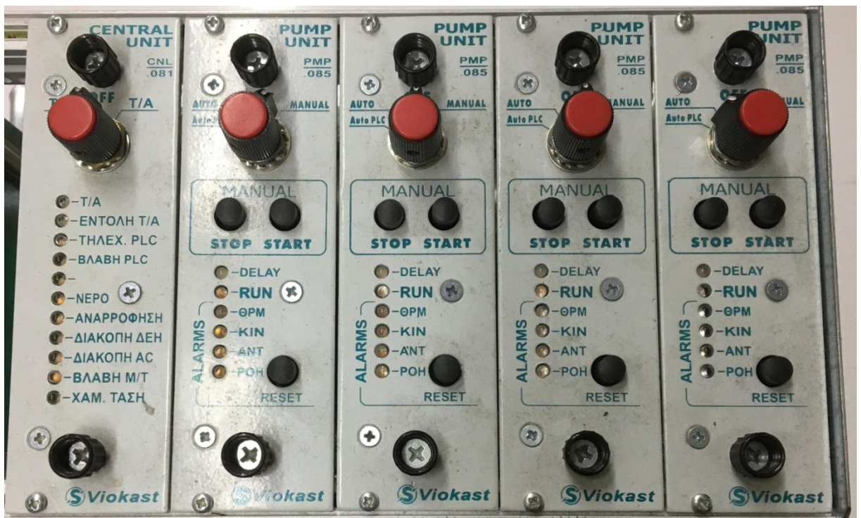
Εικόνα 5.2 Σύστημα καρτών για εγκατάσταση με τέσσερις αντλίες (χωρίς τροφοδοτικό). [5].
