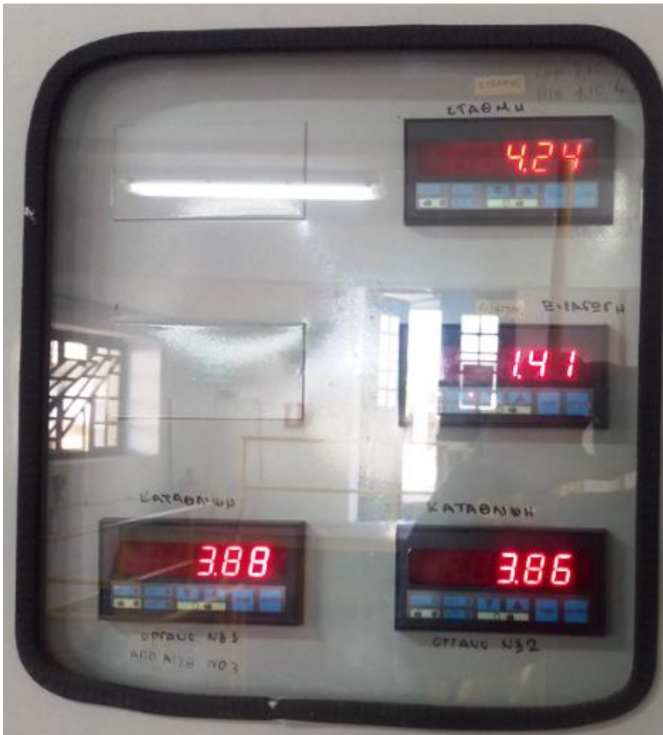
Εικόνα 3.9 Ενδείξεις αισθητηρίων σε εγκατάσταση δεξαμενής. [5].
