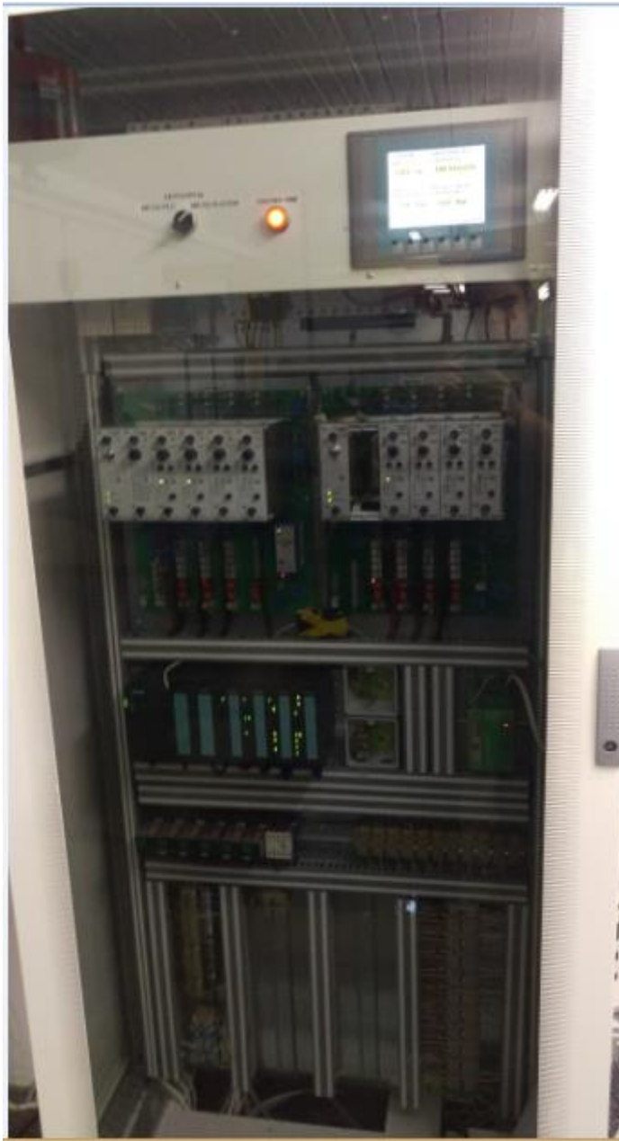
Εικόνα 2.3 Πίνακας αυτοματισμού-PLC αντλιοστασίου. [5].
