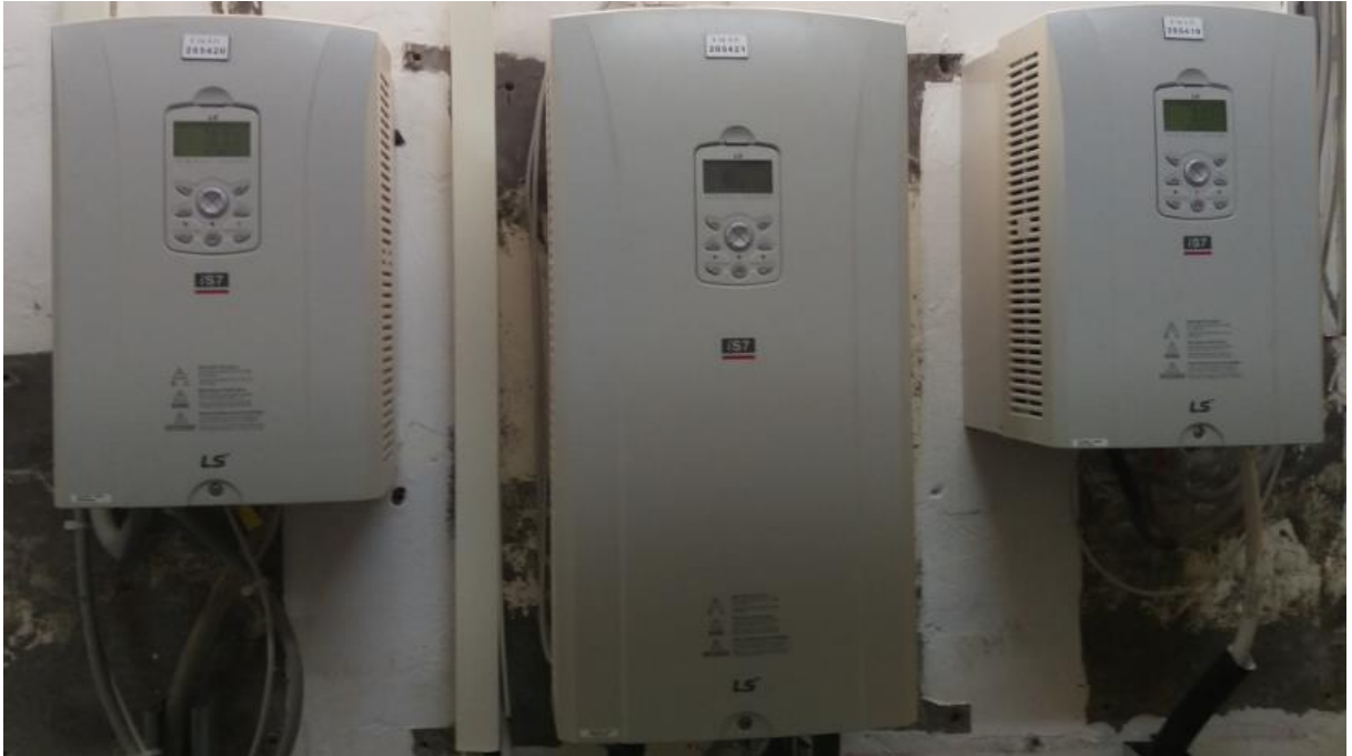
Εικόνα 8.6 Inverter της σειράς Is 7 της LG σε ΗΜ εγκατάσταση της Ε.ΥΔ.Α.Π Ν2. [5].
