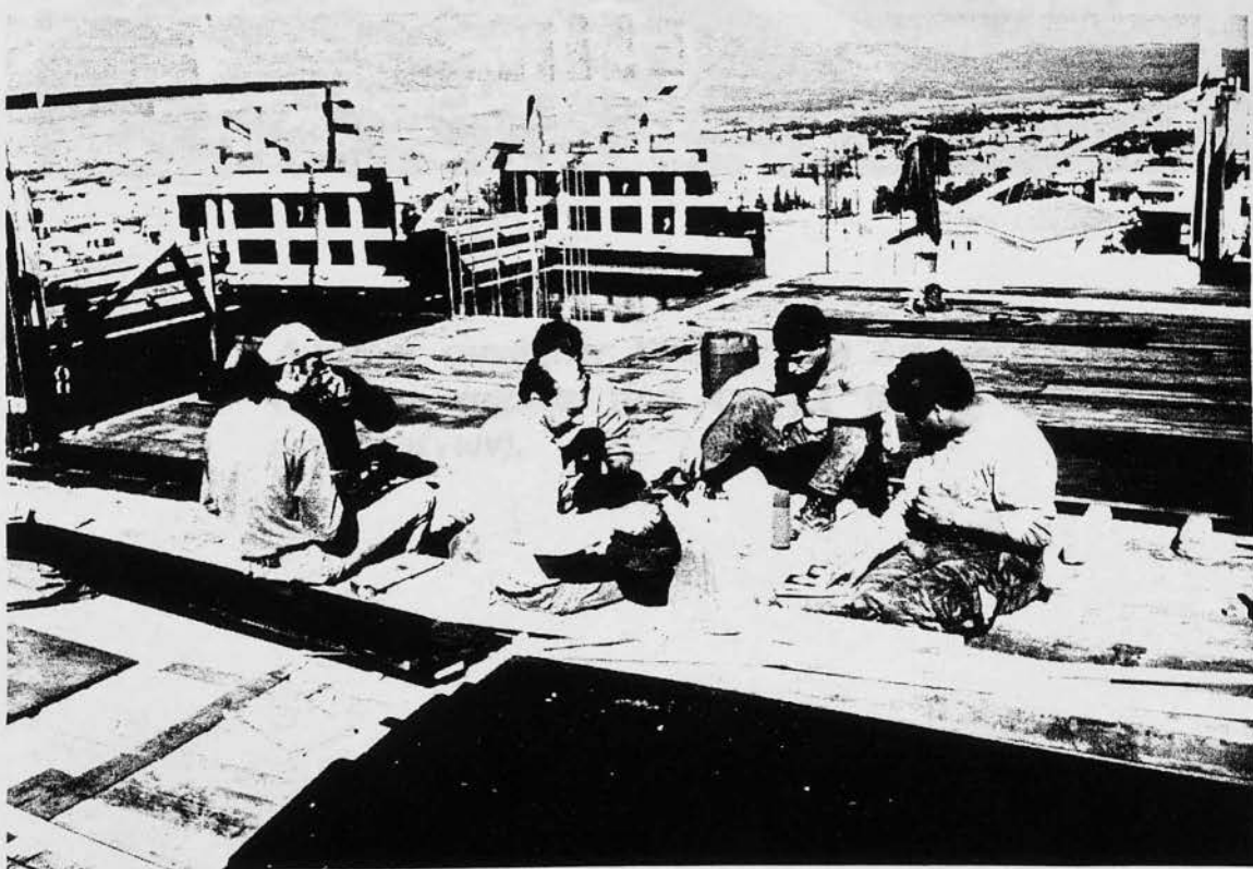
Εικόνα 1,2 : Ανυπαρξία εγκαταστάσεων για την προετοιμασία και λήψη του φαγητού.
