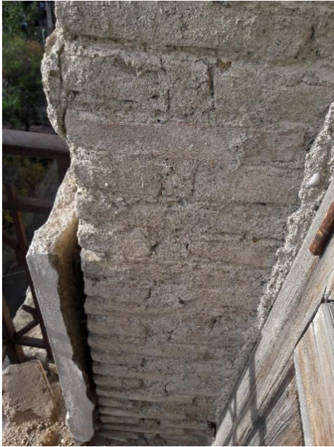
είκ. 2.17: Αποκόλληση επιχρισμάτων
