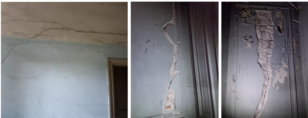
εικ. 2.6. Ρωγμές στις εσωτερικές τοιχοποιίες
