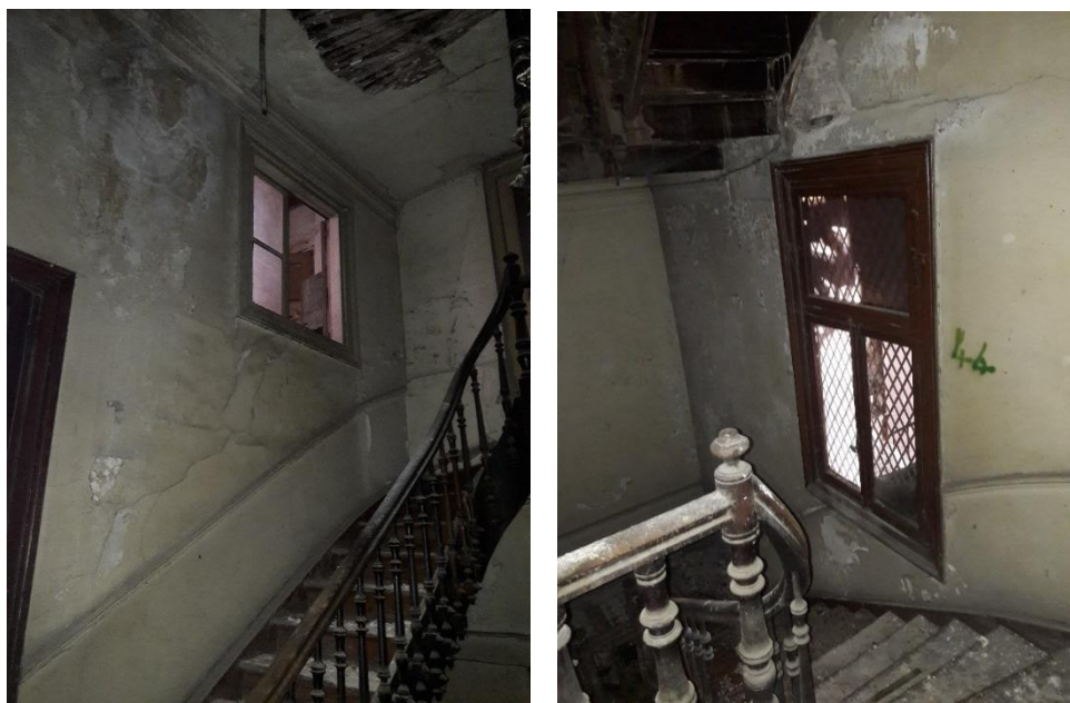
εικ. 2.7. Ρωγμές στον τοίχο τ9 του κλιμακοστασίου
