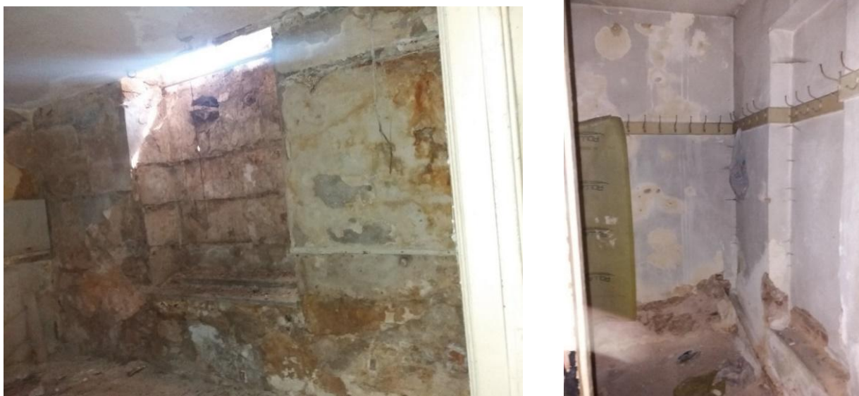
είκ. 2.6– 2.7: Υγρασία στο Υπόγειο
