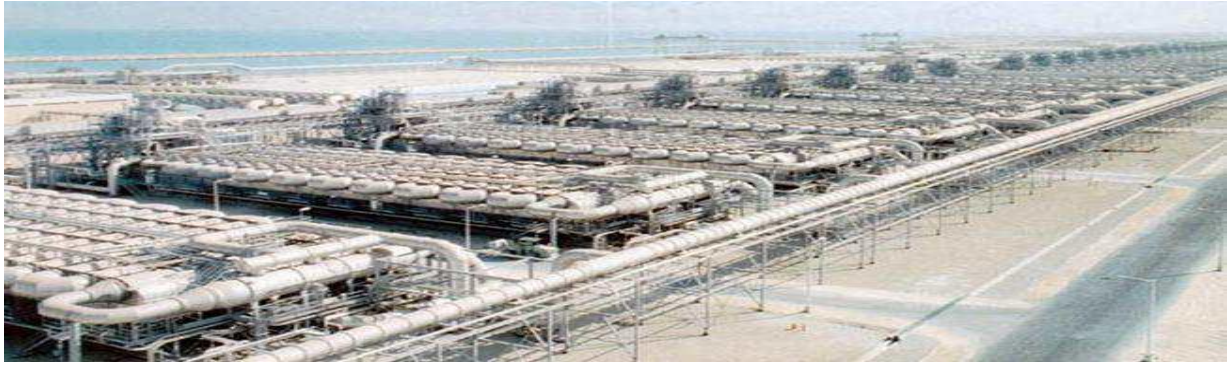
Εικόνα 4.1.1 Εγκατάσταση πολυβάθμιας εκτόνωσης στη Σαουδική Αραβία (Πηγή : Καραγάλιου,2010)
