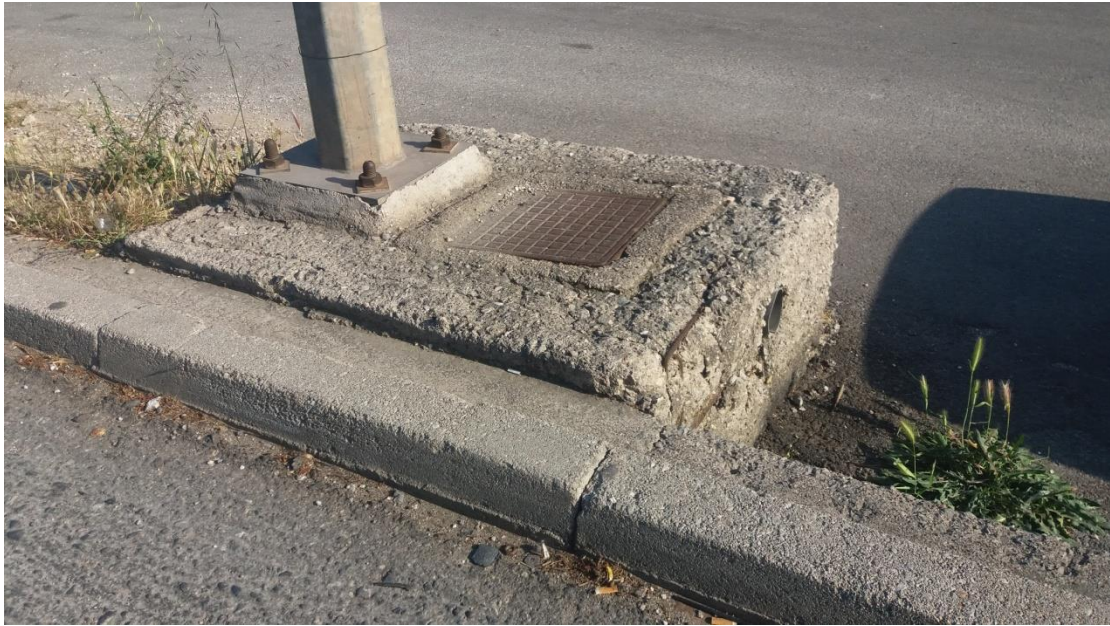
Εικόνα 26 Το οδόστρωμα πέραν της επικινδυνότητας που παρουσιάζει λόγω της κακής ποιότητας του και των κακοτεχνιών, φέρει και διάφορα εμπόδια στα τελειώματα του, όπου ενώνεται με το πεζόδρομο, με αποτέλεσμα να είναι επικίνδυνο για τους ποδηλάτες
