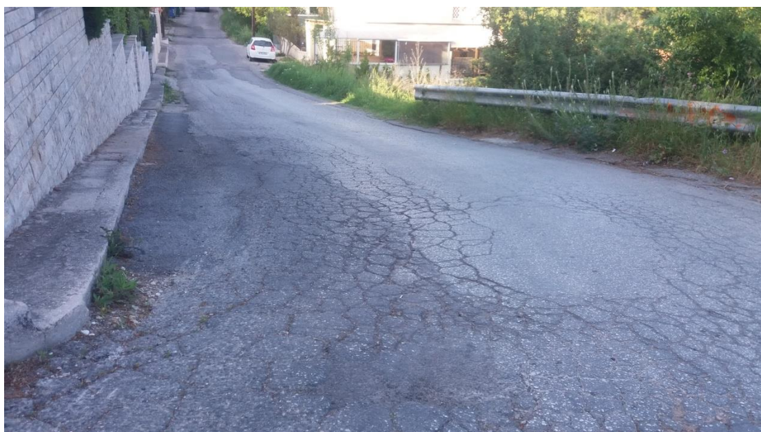
Εικόνα 38 Ρηγματώσεις και καθιζήσεις σε οδόστρωμα
