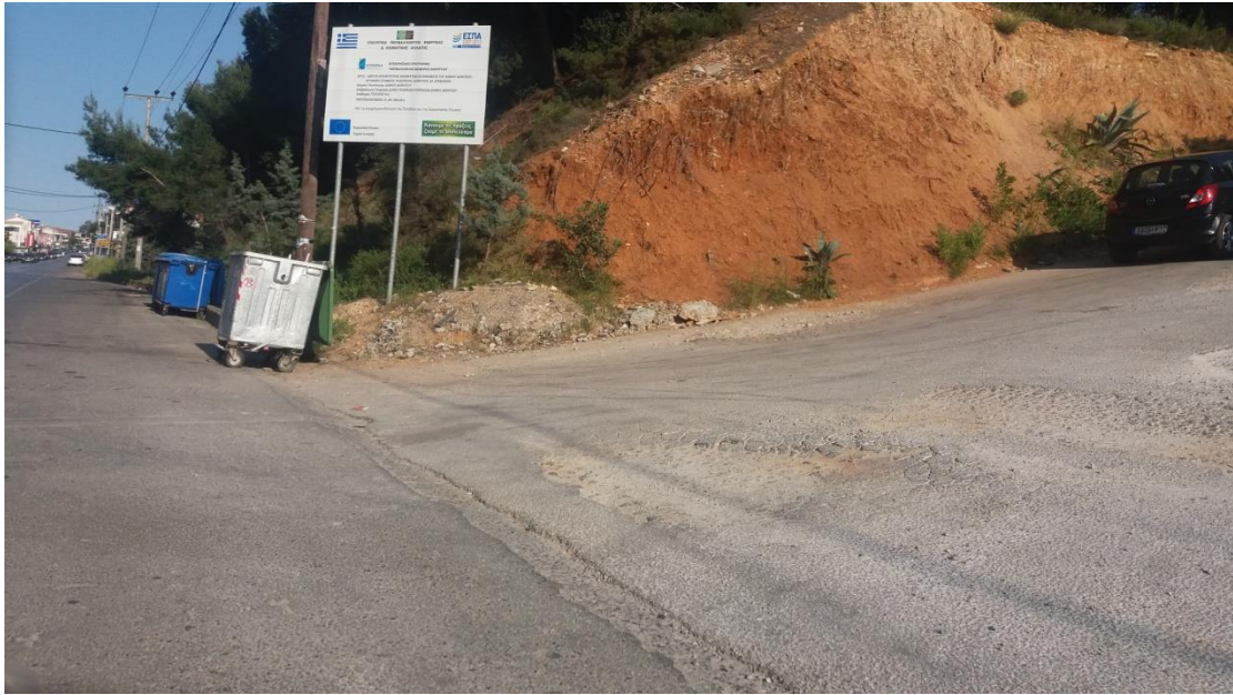
Εικόνα 40 Κακοτεχνίες στο οδικό δίκτυο του δημοτικού διαμερίσματος του Αγίου Στεφάνου
