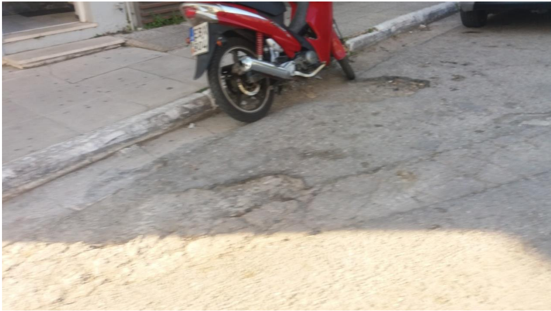
Εικόνα 30 Ρηγματώσεις και καθιζήσεις σε οδόστρωμα
