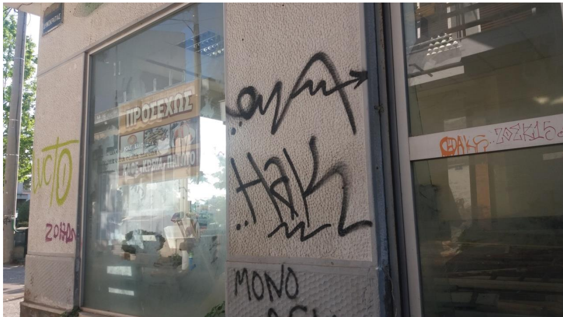
Εικόνα 45 Βανδαλισμένη πρόσοψη καταστήματος
