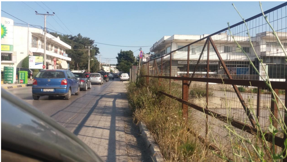
Εικόνα 31 Έλλειψη συντήρησης στα πεζοδρόμια της περιοχής
