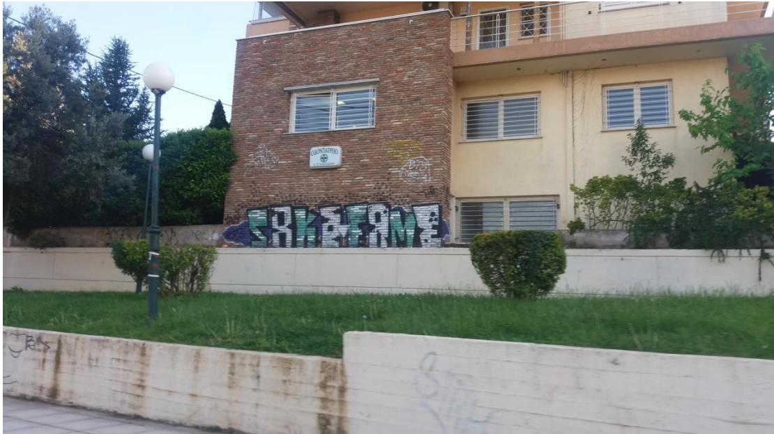
Εικόνα 42 Βανδαλισμοί με σπρευ και γκραφίτι δημόσιων κτιρίων
