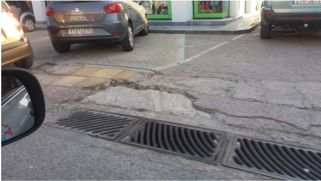
Εικόνα 46 Γενικά οι δρόμοι είχαν ικανοποιητικό αριθμό φρεατίων για τις υδατο πλημμύρες
