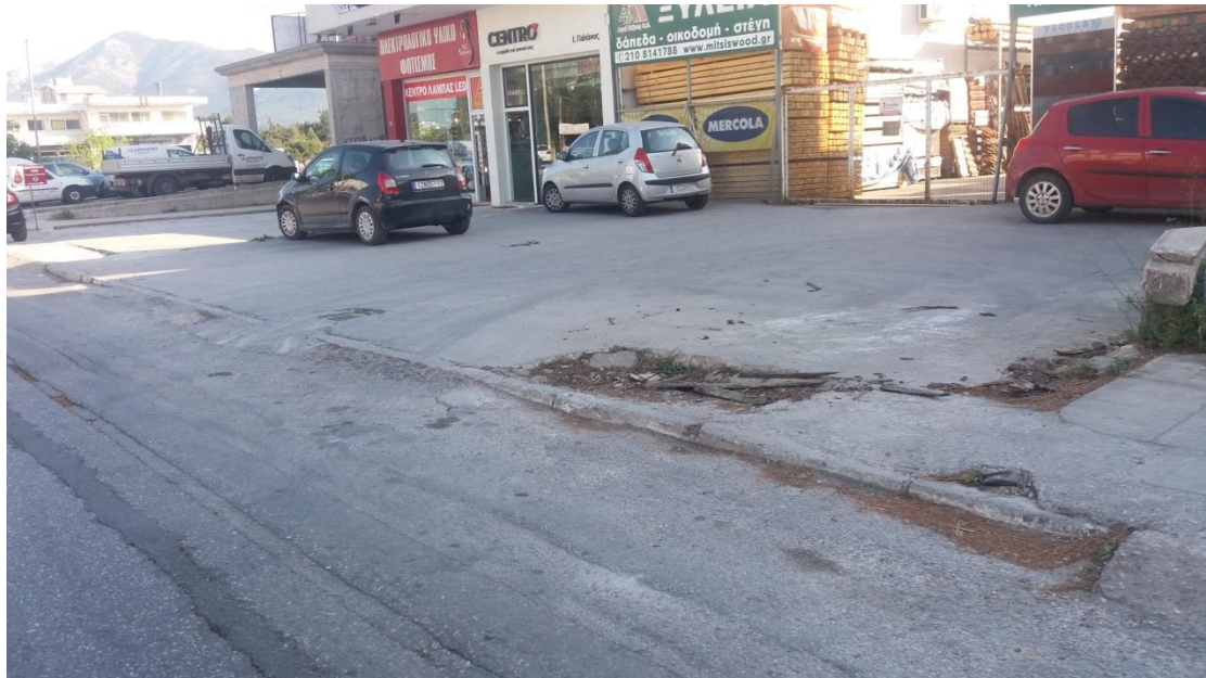
Εικόνα 32 Ρηγματώσεις και καθιζήσεις σε οδόστρωμα και πεζοδρόμιο. Παλαιά και ασυντήρητα οδοστρώματα-πεζοδρόμια καθώς και παντελώς ασυντήρητα οδοστρώματα των παλαιών επαρχιακών οδών
