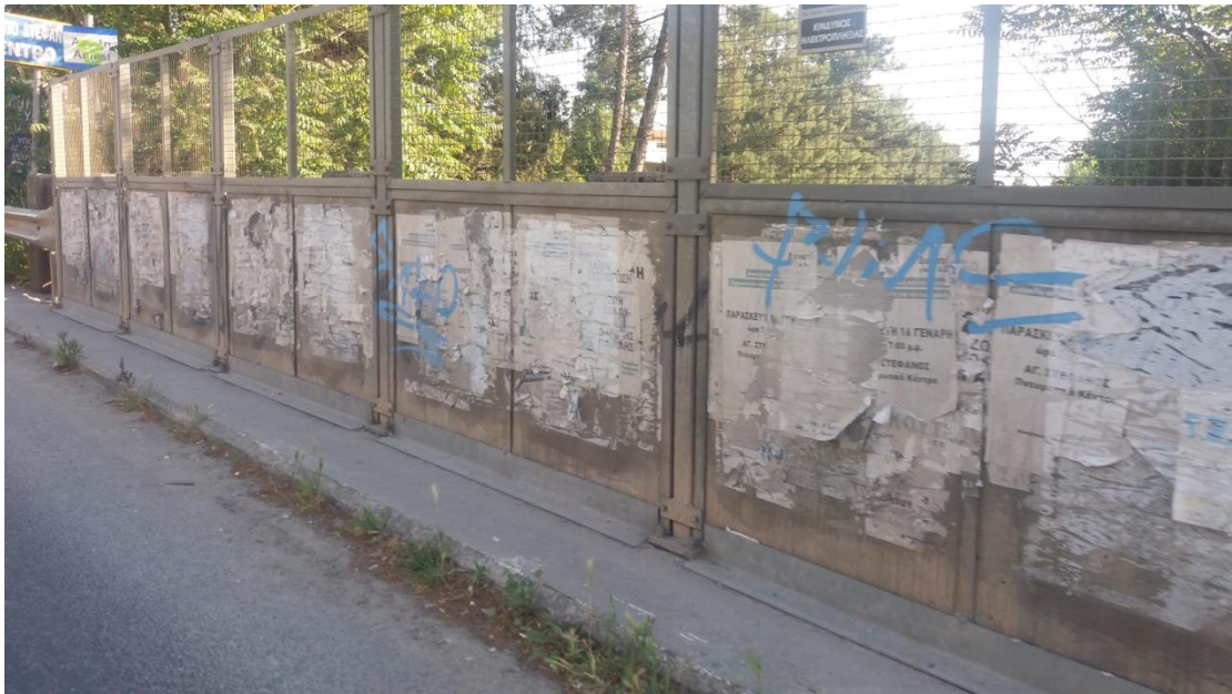
Εικόνα 41 Κακοτεχνίες στο οδικό δίκτυο του δημοτικού διαμερίσματος του Αγίου Στεφάνου
