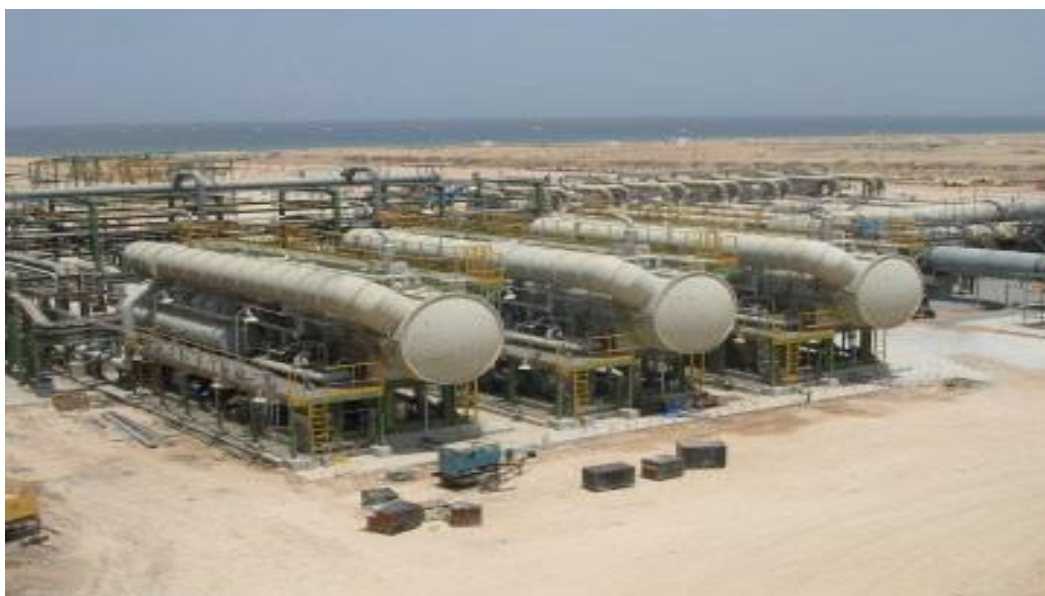
Εικόνα 13: Εγκατάσταση πολυβάθμιας εξάτμισης στο Ομάν ( 3x2400 m 3 /ημέρα) [18]
