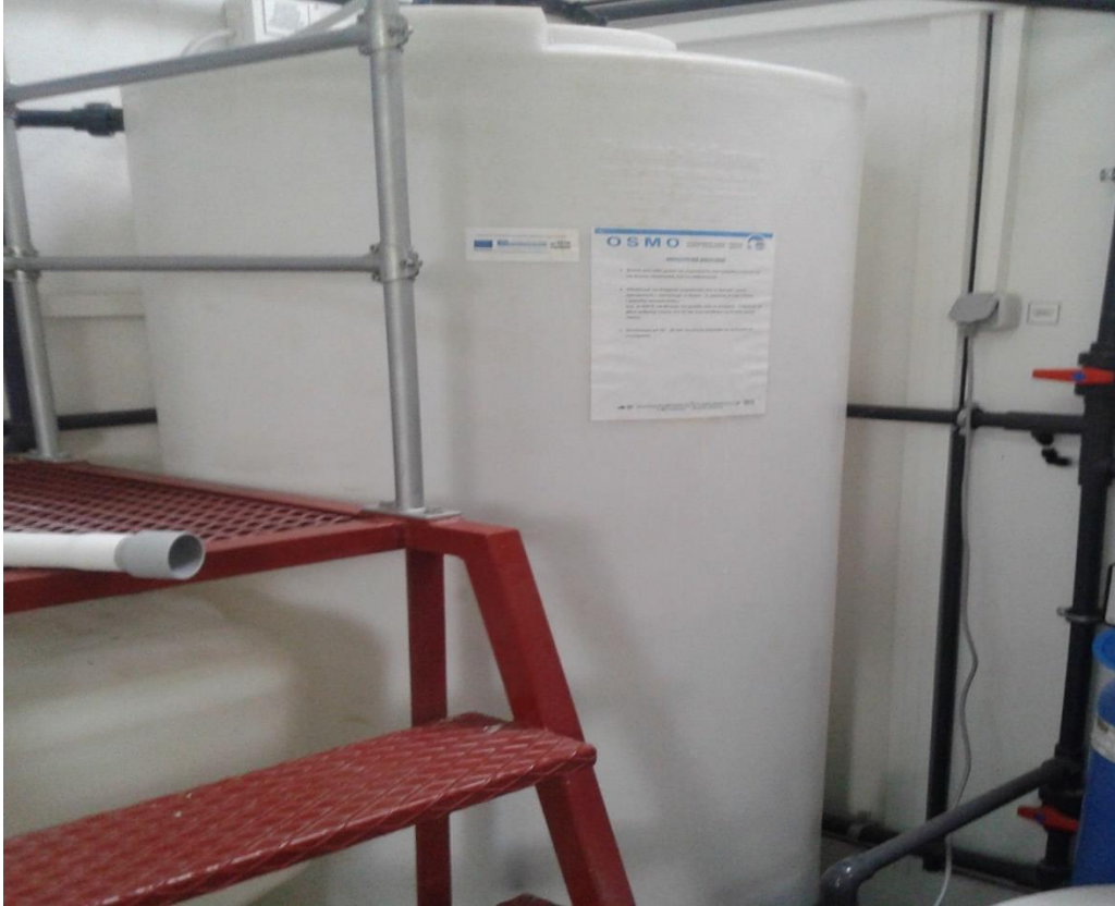
Εικόνα 39: Δεξαμενή ακάθαρτου ύδατος
