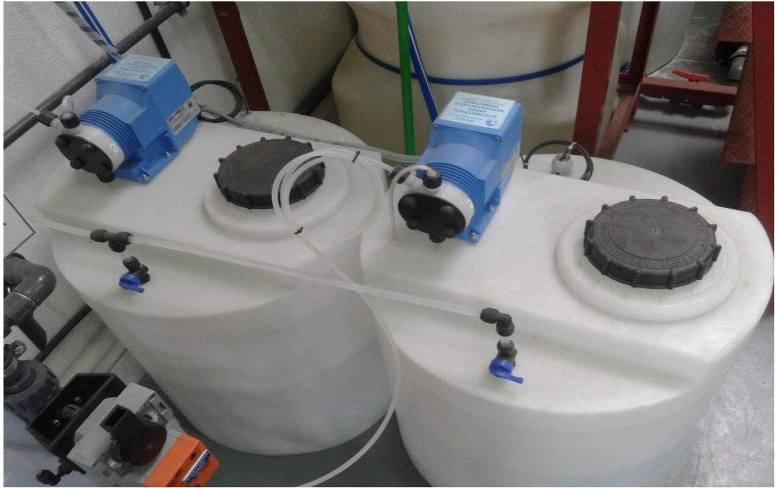
Εικόνα 41: Αριστερά η δεξαμενή αποχλωρίωσης, δεξιά η δεξαμενή αντικαθαλάτωσης
