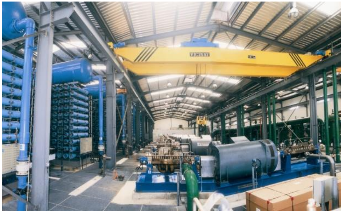
Εικόνα 18: Εγκατάσταση αντίστροφης ώσμωσης (Δεκέλεια Κύπρου, δυναμικότητα 40000 m 3 /ημέρα) [18]
