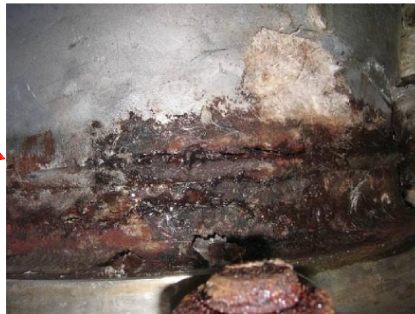
(δ) Η περιοχή ρωγμών και διαρροών που αποκαλύφθηκε μετά την αφαίρεση του καλύμματος 'Α'
