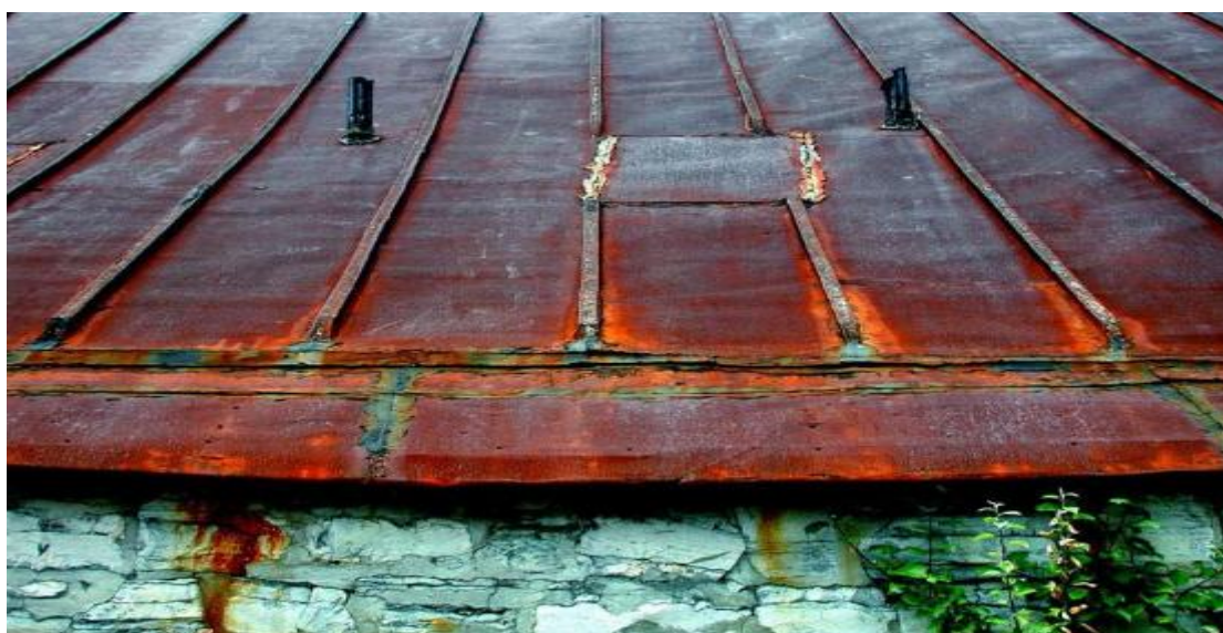
Εικόνα 9: Ομοιόμορφη διάβρωση μεταλλικής σκεπής σε ατμοσφαιρικές συνθήκες [7]
