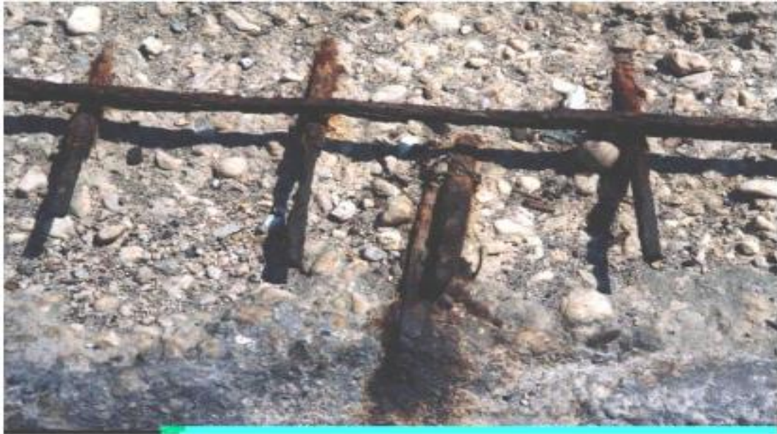
Εικόνα 22: Διάβρωση μεταλλικών αντικειμένων στο έδαφος [11]
