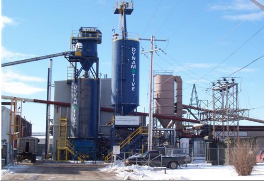
Εικόνα 46. Εγκατάσταση West Iorn
