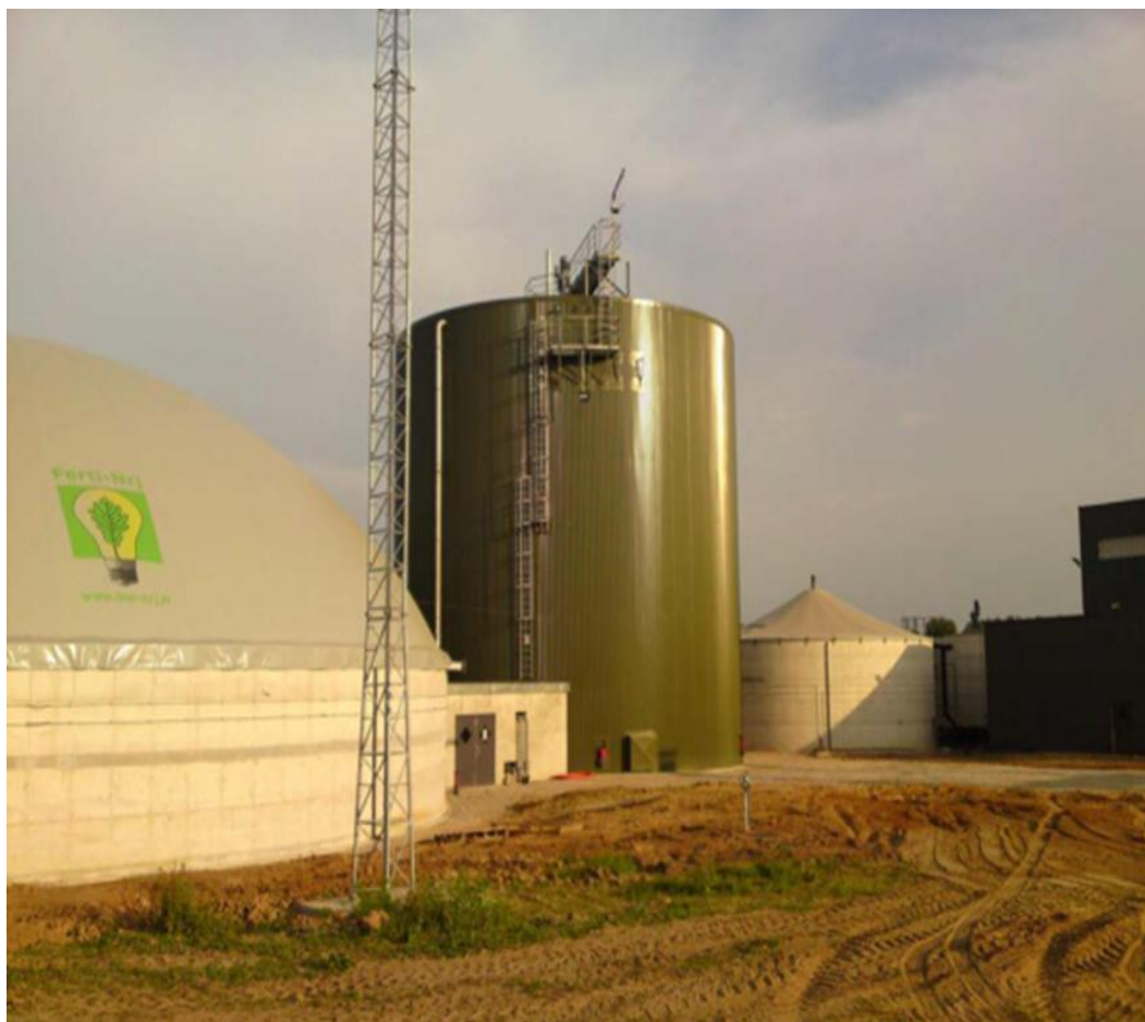
Εικόνα 56..Μονάδα επεξεργασίας λυμάτων
