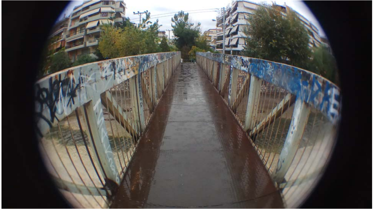
Εικόνα 9.10 Η πεζογέφυρα πάνω από τον Ιλισό, σε κακή κατάσταση
