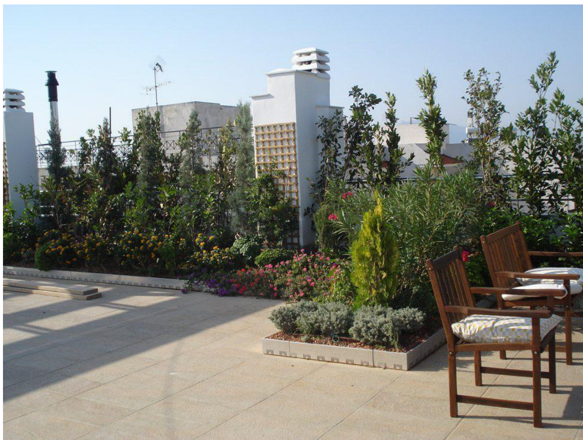
Εικόνα 35 Δώμα στο οποίο έχουν τοποθετηθεί μονωτικές πλάκες και περιμετρικά έχει κατασκευαστεί παρτέρι 80
