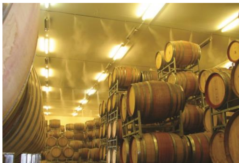
Εικόνα 4.9 Σύστημα υδρονέφωσης σε κελάρι οινοποιείου [50]
