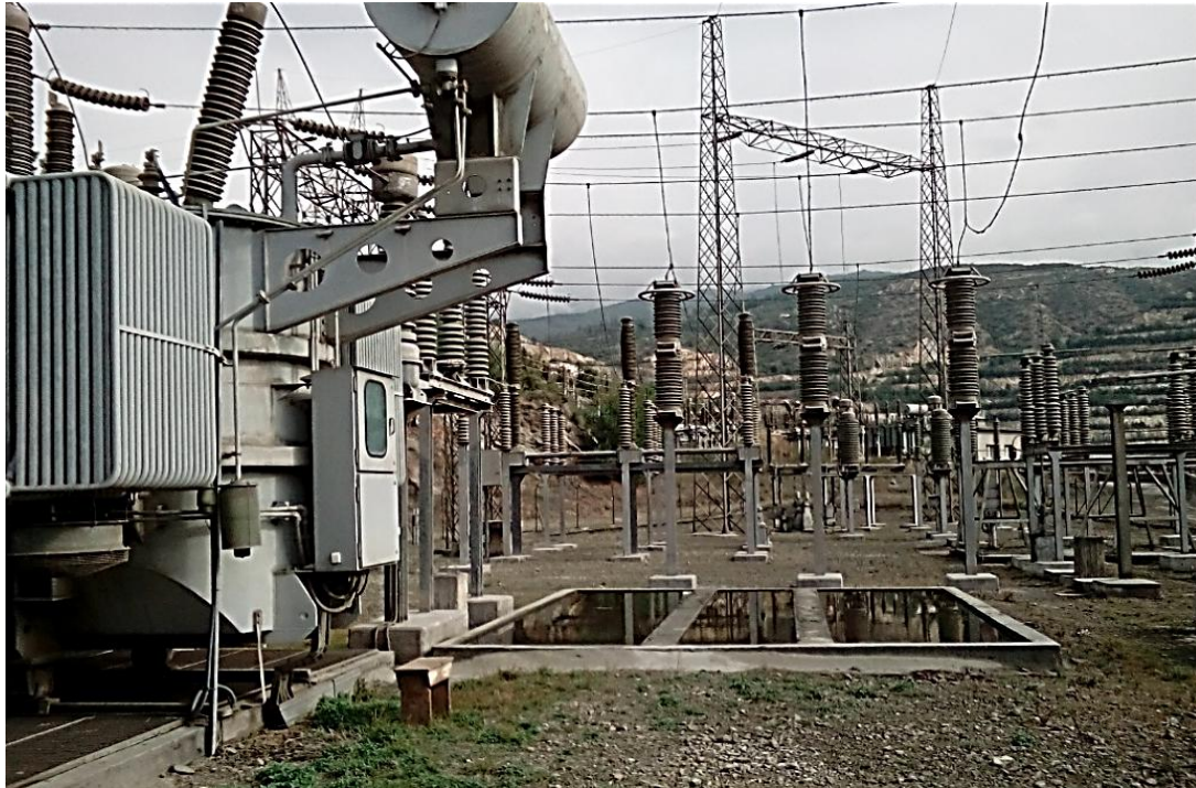
Ο Υποσταθμός Νο1 με τον μετασχηματιστή 150 / 15 / 6,6 kV ισχύος 30 MVA
