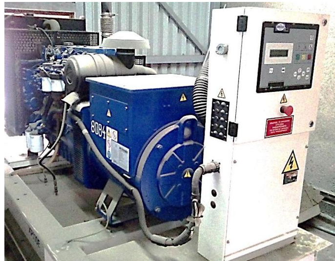
Η ντιζελο – γεννήτρια , απαραίτητος εξοπλισμός στους Υποσταθμούς
