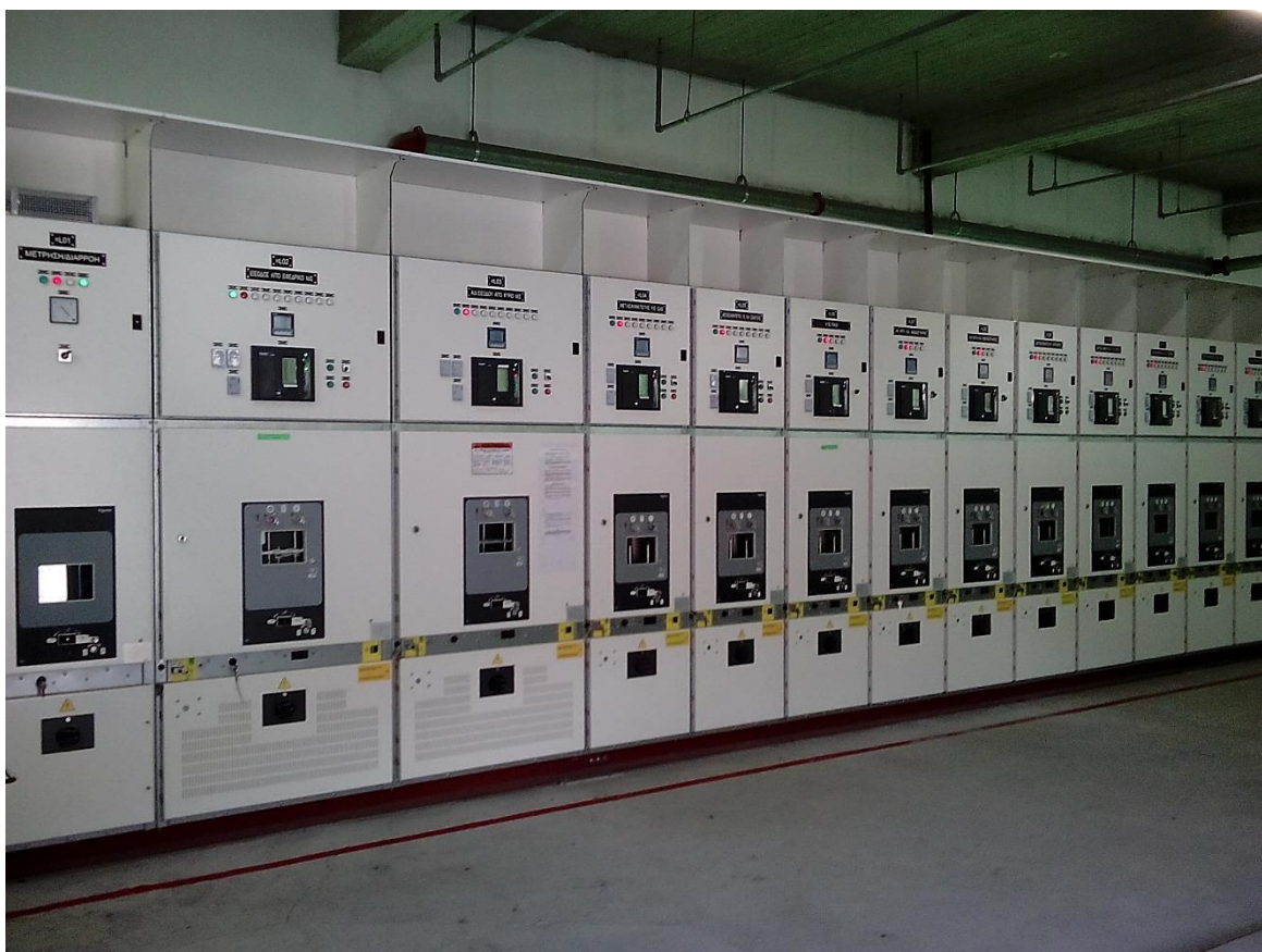
Ο πίνακας Α/Δ 6,6 kV του Υποσταθμού Νο 1
