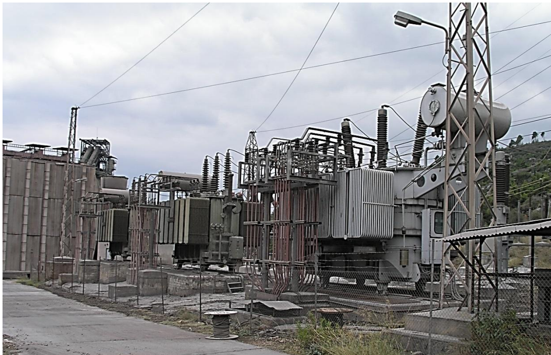
Ο Υποσταθμός Νο 2 με τους τρεις μετασχηματιστές 150 /6,6 kV ( 30-20-20 MVA)
