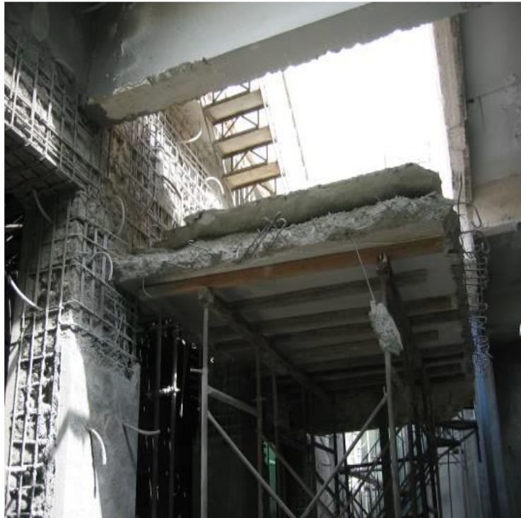
Πηγή ως άνω, φωτ.7 : πλάκα μηχανολογικών
