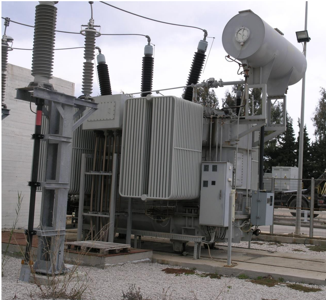
Μετασχηματιστής ανύψωσης Αεριοστρόβιλου Νο4 ΜΣ94(ELEKTROPUTERE)
