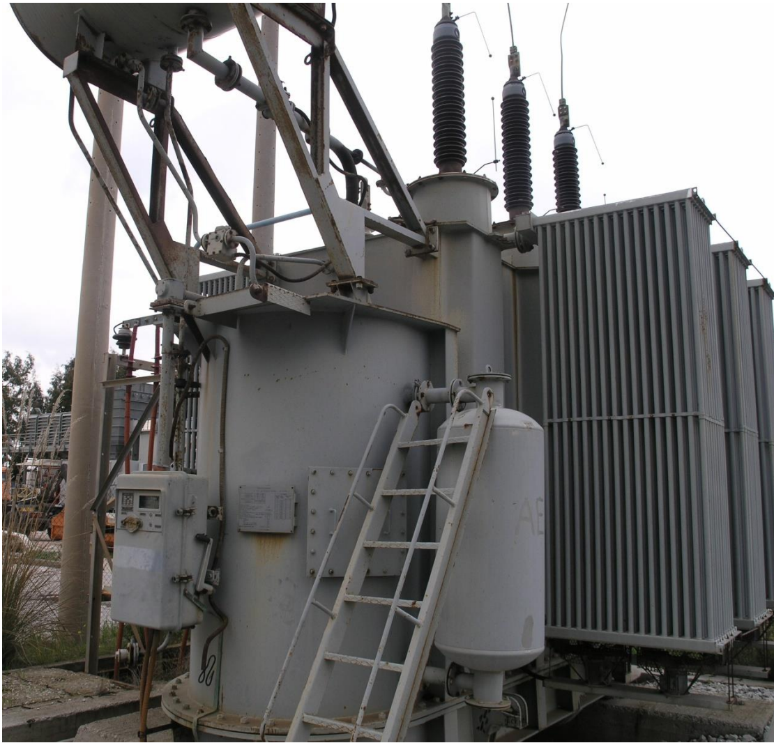
Μετασχηματιστής ανύψωσης Αεριοστρόβιλου Νο2 ΜΣ92(ZTR UKRAINE)
