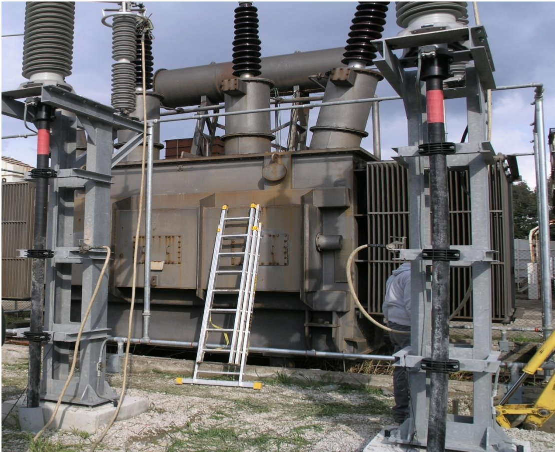
Μετασχηματιστής ανύψωσης Αεριοστρόβιλου Νο1 ΜΣ91 (THOMASSEN)
