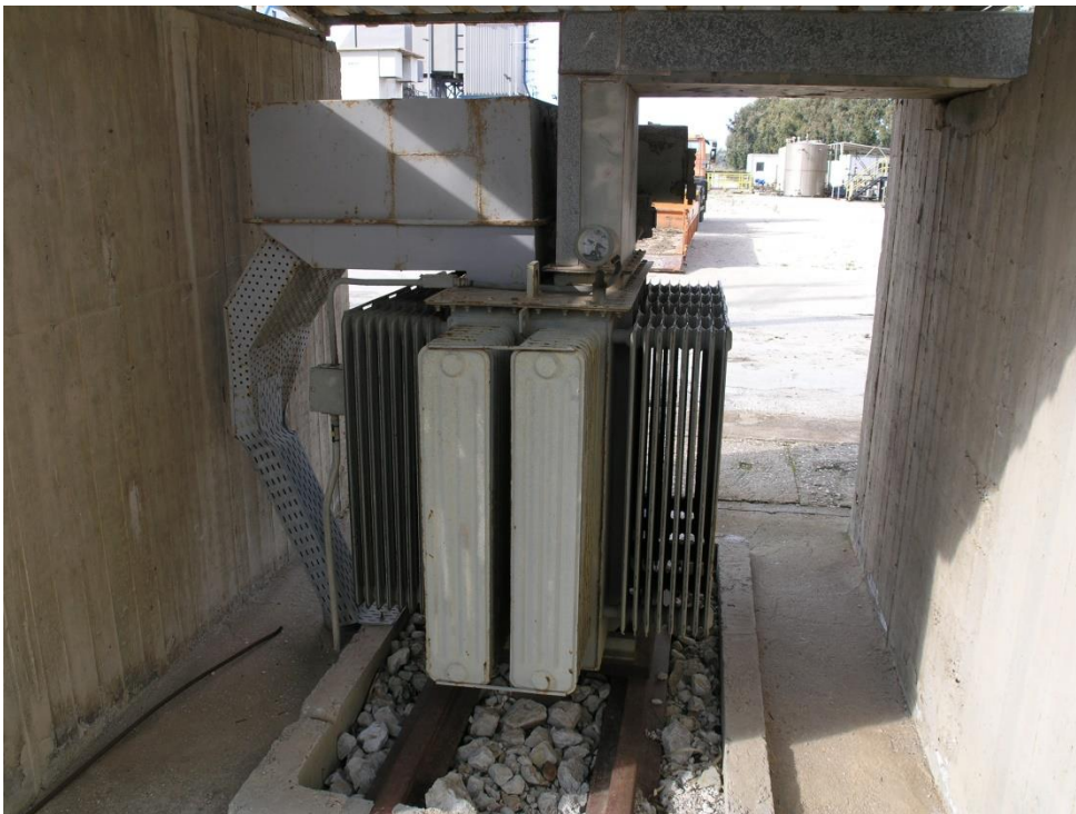
Μετασχηματιστής υποβιβασμού Αεριοστρόβιλου Νο2 ΒΜΣ92β(ΑΕΓ) για την τροφοδότηση των βοηθητικών του κυκλωμάτων.
