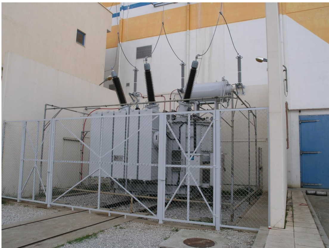
Ένας από τους μετασχηματιστές ανύψωσης μονάδων PIELSTICK3(ΜΣ6) & PIELSTICK4(ΜΣ7) & PIELSTICK 5(ΜΣ8)
