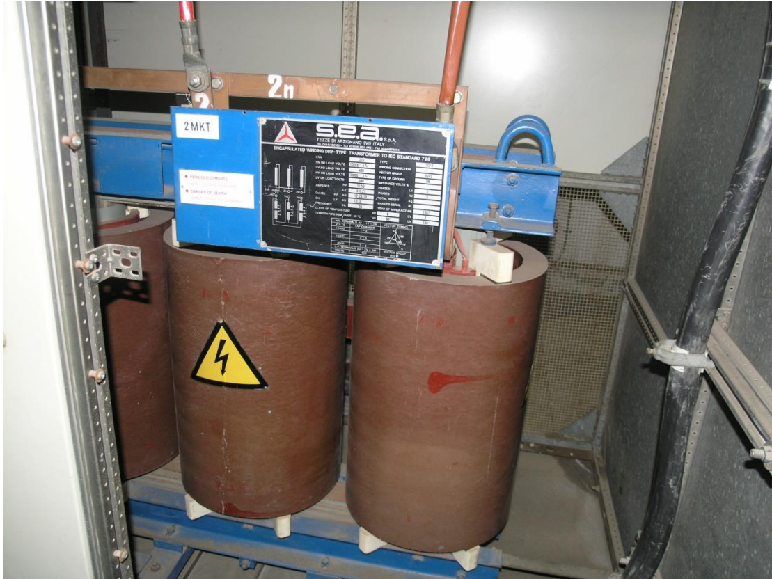
Μετασχηματιστές διέγερσης SULZER1 & SULZER2
