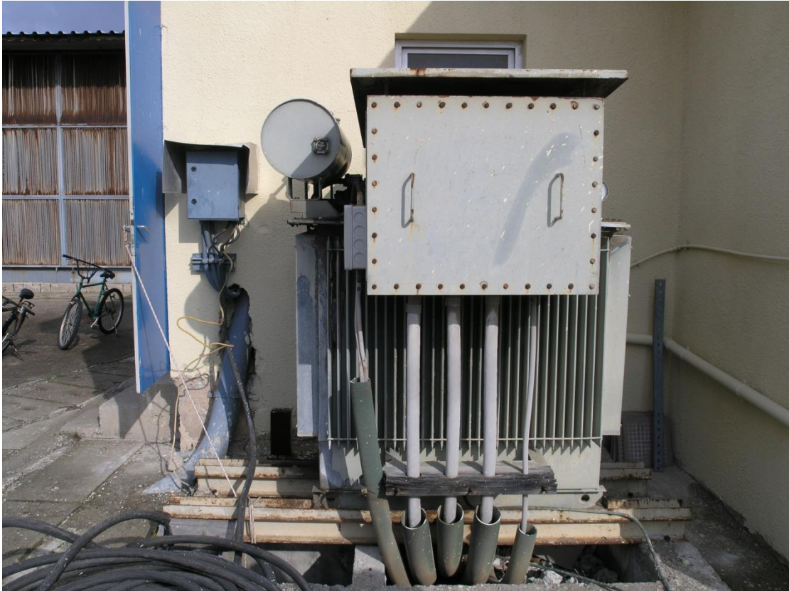
Μετασχηματιστής υποβιβασμού Αεριοστρόβιλου Νο1 ΒΜΣ91(THOMASSEN) για την τροφοδότηση των βοηθητικών του κυκλωμάτων
