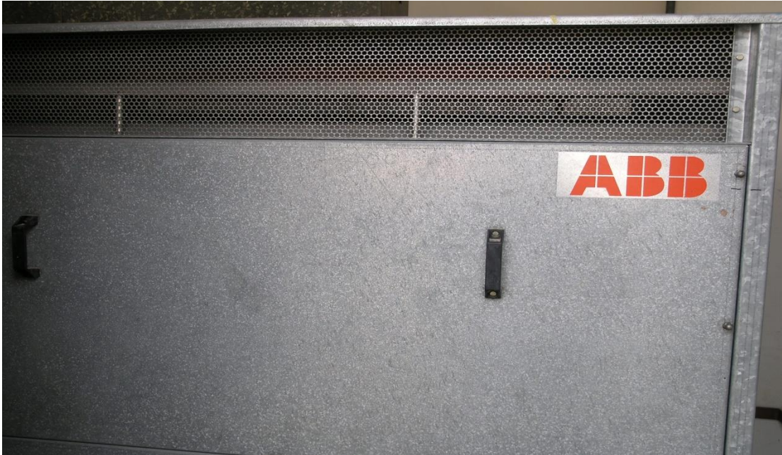
Μετασχηματιστής υποβιβασμού Αεριοστρόβιλου Νο3 ΒΜΣ93 για την τροφοδότηση των βοηθητικών του κυκλωμάτων.
