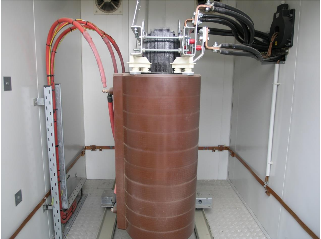
Μετασχηματιστής υποβιβασμού Αεριοστρόβιλου Νο2 ΒΜΣ92α(TRAFFO) για την τροφοδότηση των βοηθητικών του κυκλωμάτων.
