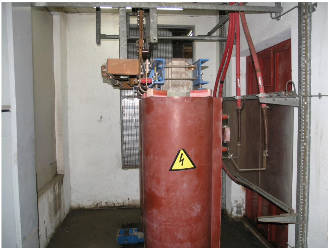
Διασυνδεδετικός μετασχηματιστής γενικών βοηθητικών από ΑΗΜ1 & ΑΗΜ2 σε γενικά βοηθητικά SULZER1 & SULZER2
