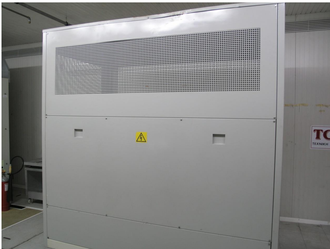
Μετασχηματιστής υποβιβασμού Αεροστροβίλου Νο4 ΒΜΣ94(MERLIN GERIN) για την τροφοδότηση των βοηθητικών του κυκλωμάτων.
