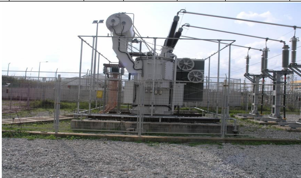
Μετασχηματιστής ανύψωσης Αεριοστρόβιλου Νο3 ΜΣ93(ABB)
