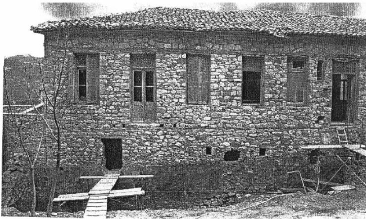
Εικ. 13.6: Άποψη της ΒΑ πτέρυγας από βορρά, μετά την αφαίρεση των επιχρισμάτων, όπου φαίνεται ο τρόπος δόμησης των τοιχοποιιών του 3 ου και 4 ου ορόφου και η κατάσταση διατήρησης του μνημείου.
