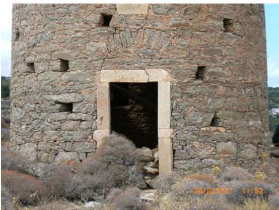
Εικ. 4.9: Παράδειγμα απεικόνισης βλαβών στο πλαίσιο του ανοίγματος (πρέκι) και στο υπόλοιπο της τοιχοποιίας.
