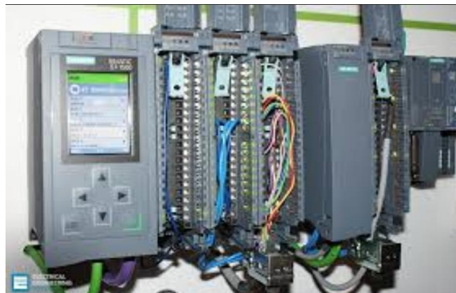
Εικόνα 5. Διατάξεις PLC/SIMATIC S7-1500 σε βιομηχανική μονάδα (προσαρμογή από http://electrical-engineering-portal.com ).
