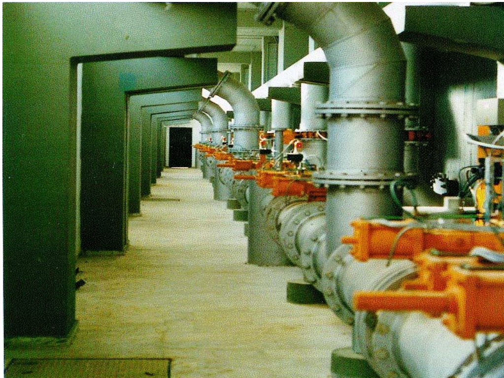
Σύστημα δεξαμενών ΕΥΔΑΠ(Αρχείο ΕΥΔΑΠ)
