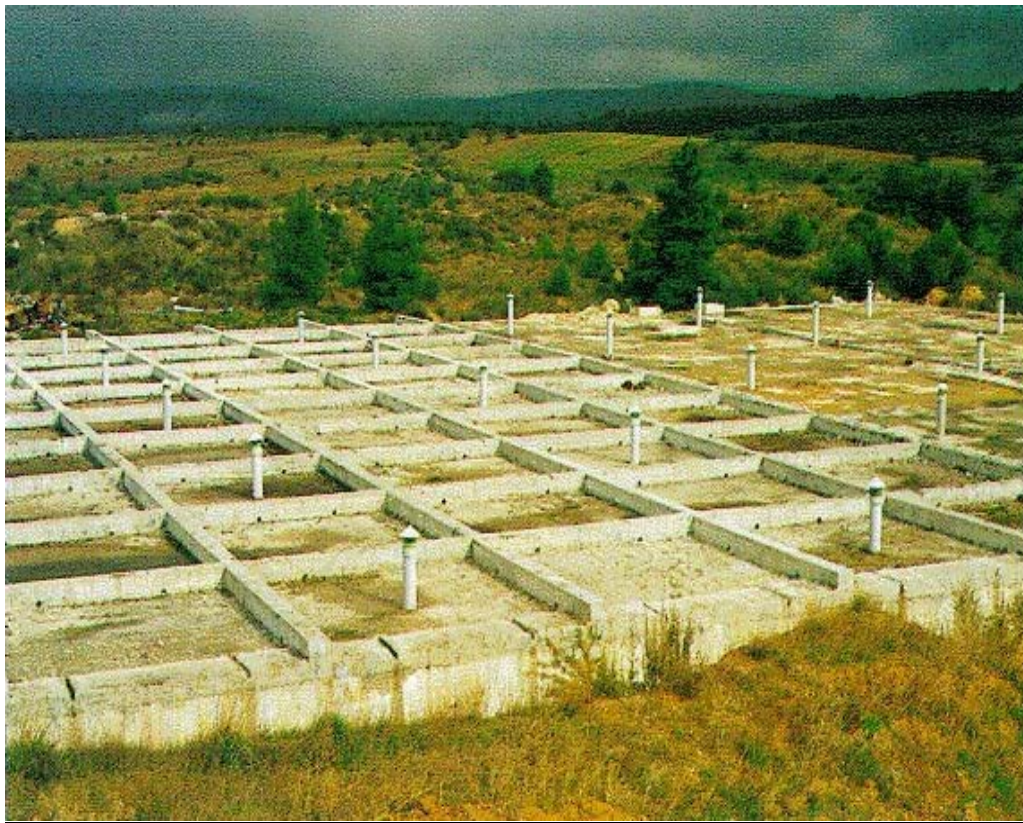
Δεξαμενές Καθίζησης(Αρχείο ΕΥΔΑΠ)
