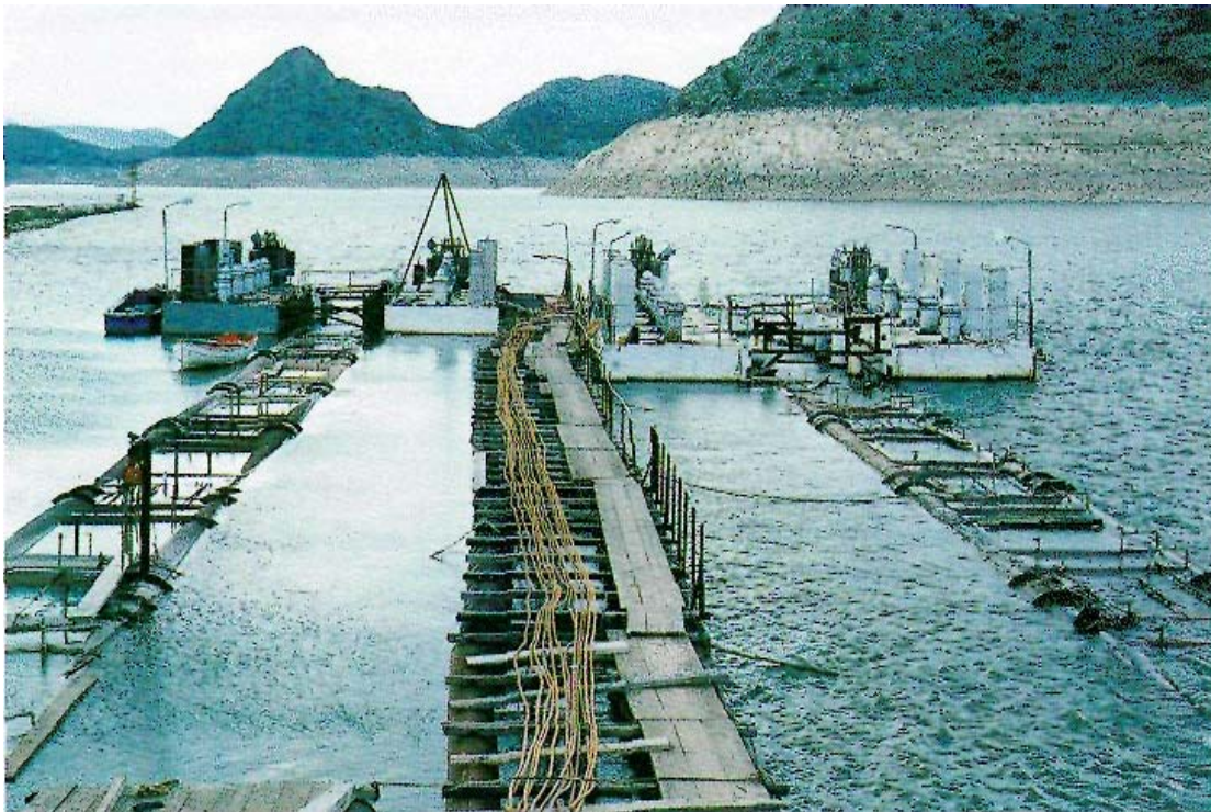
Πλωτό αντλιοστάσιο Υλίκης(Αρχείο ΕΥΔΑΠ)
