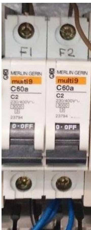
Εικόνα 24 Διακόπτες προστασίας διάταξης
