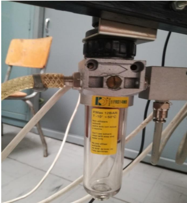
Εικόνα 29 Μονάδα συντήρησης (πίσω όψη)
