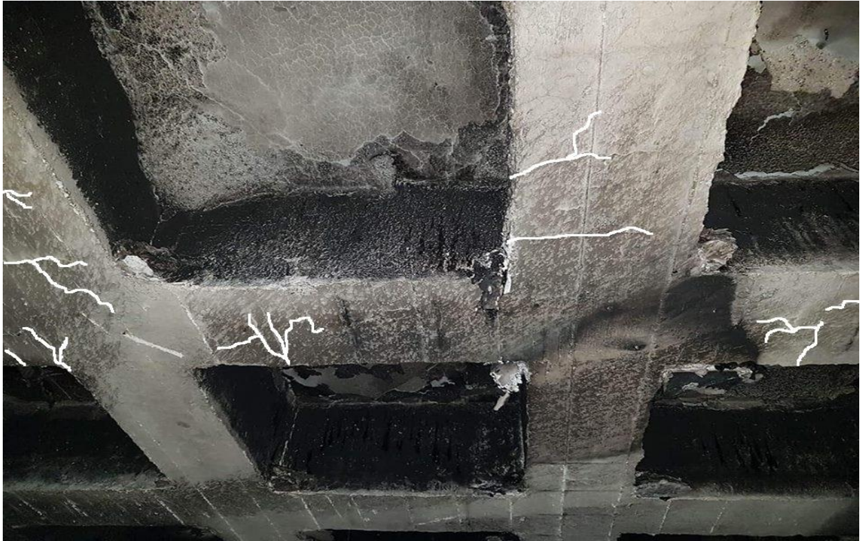
Εικ.2: Καμένη δοκιδωτή πλάκα σε όροφο-διαμέρισμα μετά από πυρκαγιά, αποκολλήσεις επιχρισμάτων και ελαφριές ρηγματώσεις δοκών.
