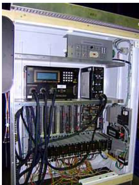
Εικόνα 1. Μηχανοποιημένο κιβώτιο ελέγχου κυκλοφορίας
