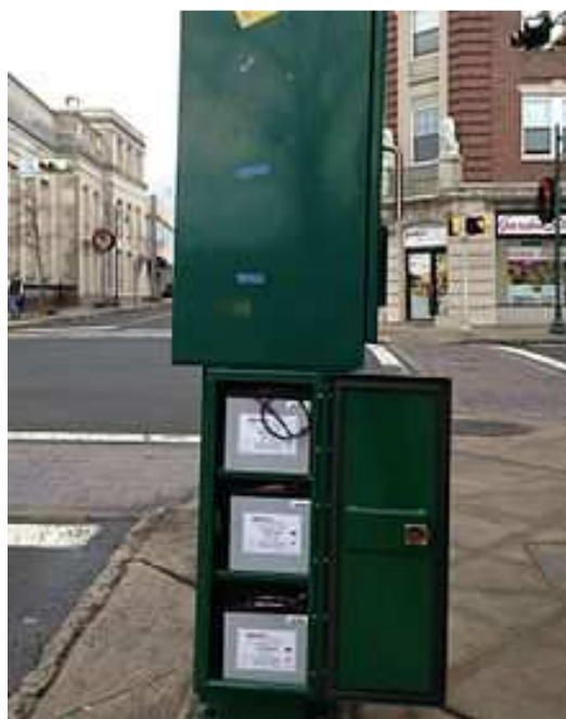
Εικόνα 2. Τα αντίγραφα ασφαλείας των μπαταριών εγκαθίστανται σε ξεχωριστό περίβλημα από τον πίνακα ελέγχου κυκλοφορίας στην κορυφή.
