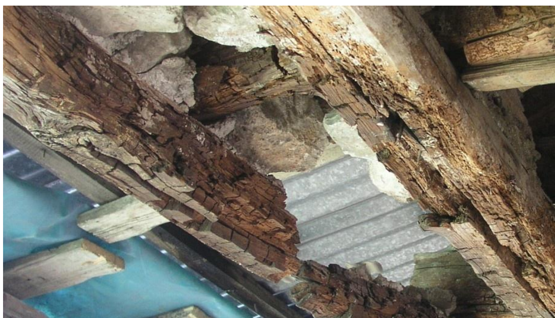
Εικόνα 54 Καμμένα στοιχεία ξύλινου στέγαστρου
