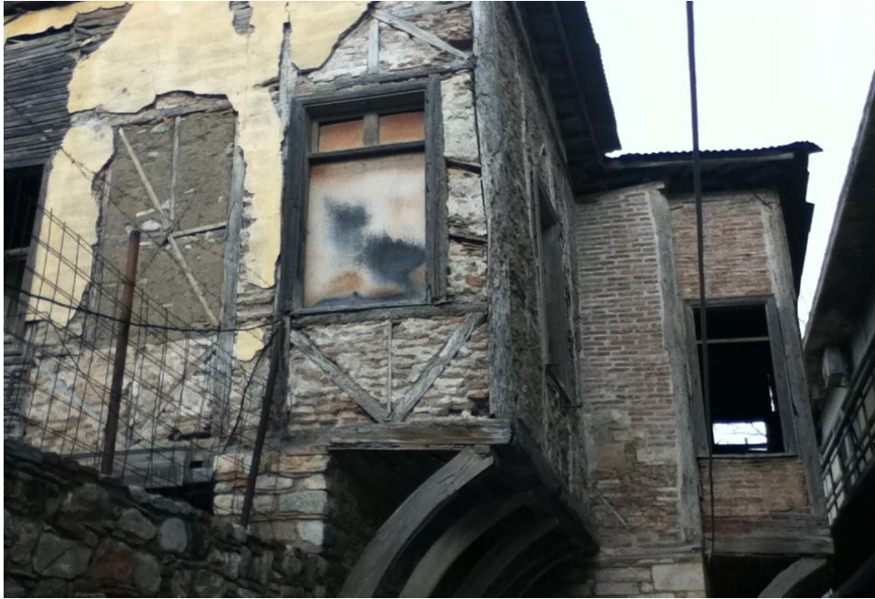
Εικόνα 27 Διατηρητέο κτίριο στη Χαλκίδα, όπου ο άνω όροφος είναι κατασκευασμένος από ξυλόπηκτη τοιχοποιία
