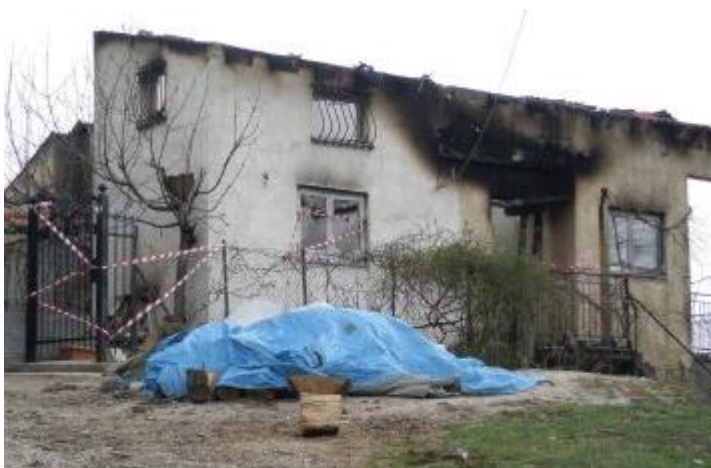
Εικόνα 56 Καμμένο κτίσμα στη Γκίωνα
