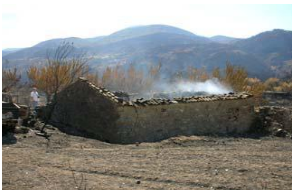
Εικόνα 53 Κτίριο καμμένο εσωτερικά
