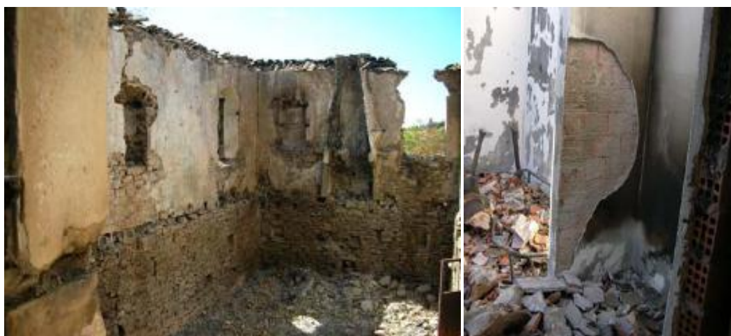
Εικόνα 66 Αποκόλληση και πτώση επιχρισμάτων
