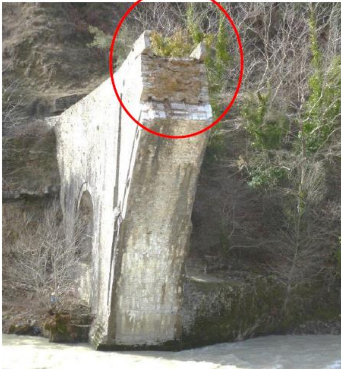
Εικόνα 56 Άποψη του δεξιού ακροβάθρου μετά την κατάρρευση. Μεταξύ του κεντρικού τόξου και των τυμπάνων του, υπάρχει μια περιοχή υλικού πληρώσεως, το οποίο μοιάζει να αποτελείται από μικρούς λίθους και χώμα.
