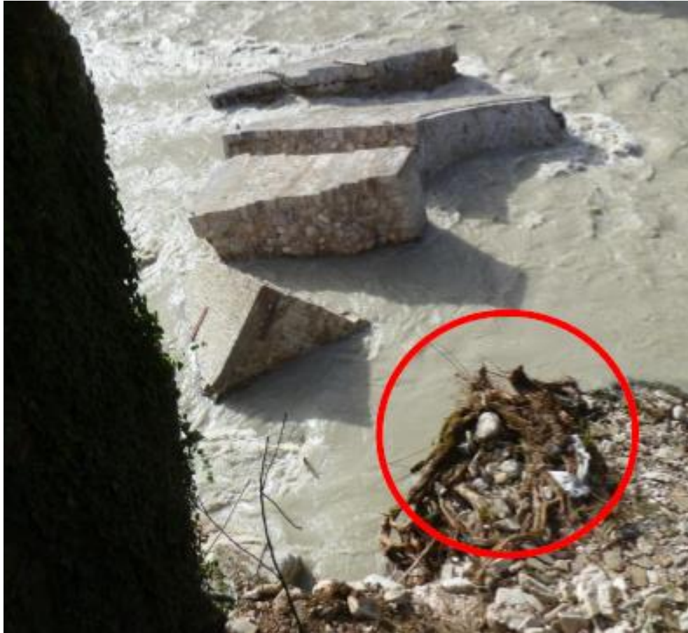
Εικόνα 55 Υπολείμματα της ρίζας του πλατάνου (σημειώνονται μέσα στον κόκκινο κύκλο), ακριβώς ανάντη του αριστερού βάθρου της γέφυρας. Εντός της κοίτης φαίνονται τμήματα του αριστερού βάθρου της γέφυρας.
