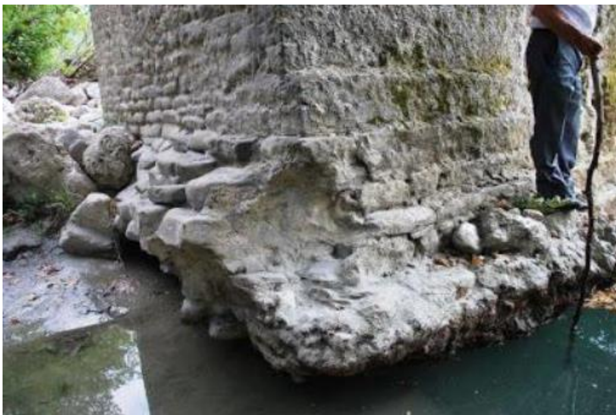
Εικόνα 52 Βάση του αριστερού βάθρου της γέφυρας (βορειοδυτική γωνία) σε παλαιότερη περίοδο χαμηλών υδάτων. Φαίνεται η έντονη διάβρωση του βάθρου και η υποσκαφή της θεμελίωσης.
