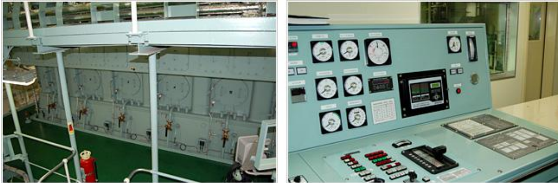
Εικόνα 3.21: Στροφαλοθάλαμος μηχανής και θάλαμος ελέγχου μηχανοστασίου (ECR) με εγκατεστημένη κεντρική μονάδα DAIHATSU MD-SX [27].
