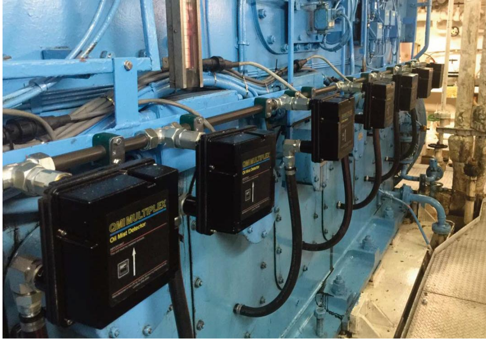
Εικόνα 3.23: Τοποθετημένο σύστημα ανίχνευσης QMI Multiplex [25].
