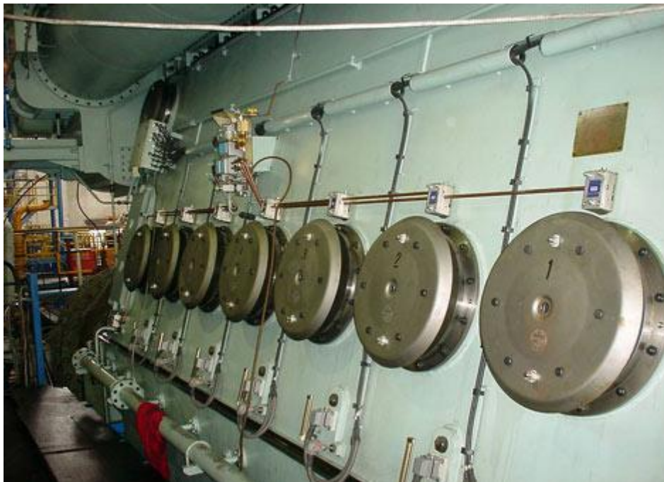
Εικόνα 2.3: Εξωτερική όψη στροφαλοθάλαμου κύριας μηχανής πλοίου, με στρογγυλές πόρτες εκτόνωσης (relief doors) [10].
