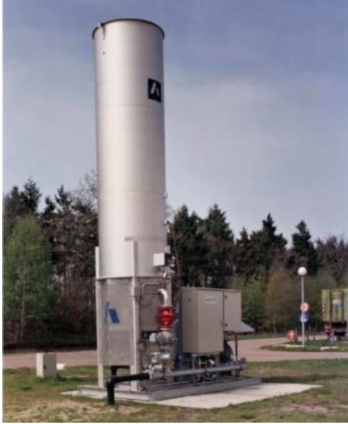
Εικόνα 3.5 Πυρσός καύσης βιοαερίου
