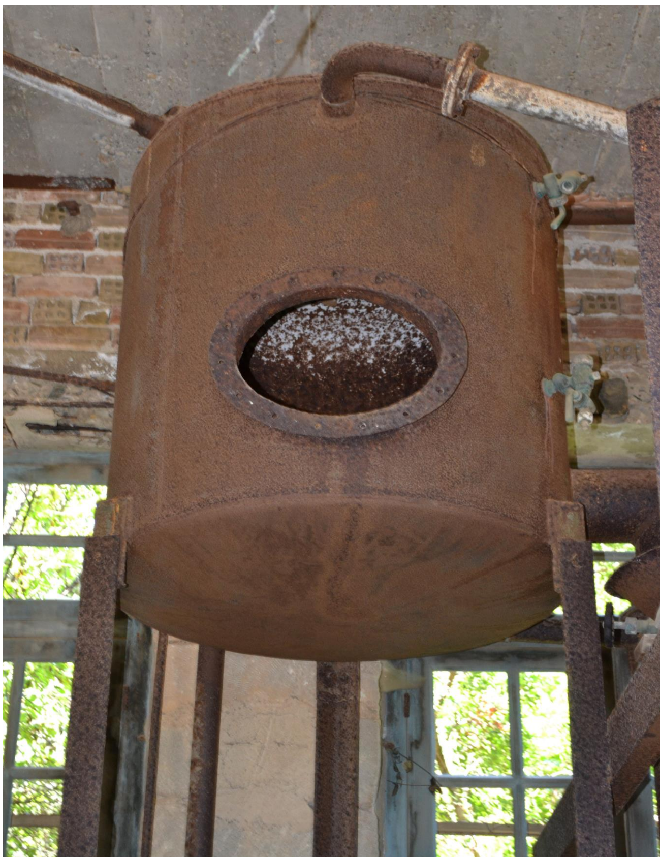
Εικόνα 3.182 Μπόιλερ ζεστού νερού
