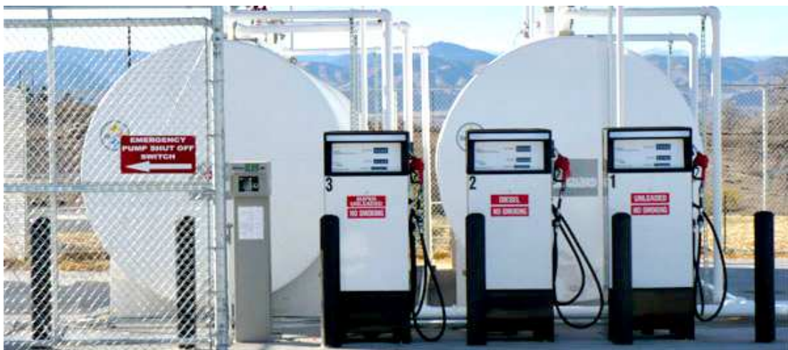
Εικ. 3.2.5: Εγκατεστημένες υπέργειες δεξαμενές σε πρατήριο υγρών καυσίμων
