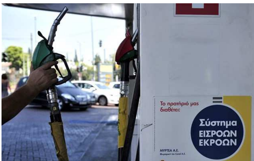
Εικ. 4.1.1: Φωτογραφία από πρατήριο υγρών καυσίμων με εγκατεστημένο σύστημα Εισροών - Εκροών
