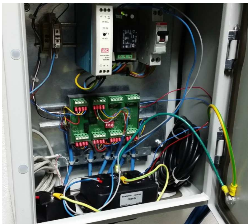
Εικ. 3.7.6: Ηλεκτρολογικό κουτί controller της εταιρίας Fafnir συνδεδεμένο σε πρατήριο
