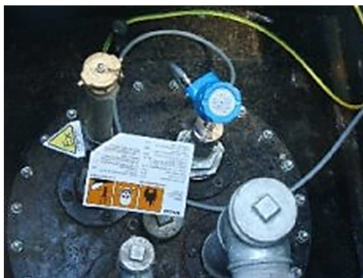
Εικ. 3.6.2: Απεικόνιση ανθρωποθυρίδας υπόγειας δεξαμενής με τοποθετημένο αισθητήρα μέτρησης στάθμης
