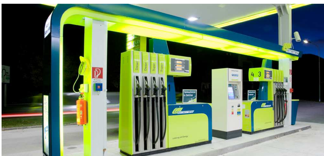
Εικ. 3.3.1: Διανομείς υγρών καυσίμων σε πρατήριο
